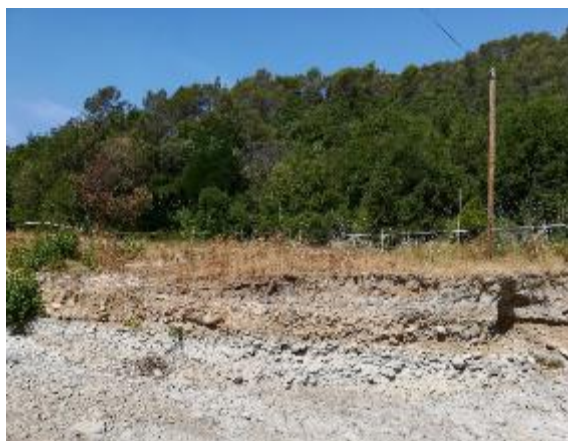
Figure 16: Poteau électrique menacé par l'érosion
