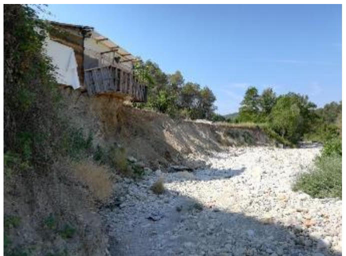
Figure 14: Vue sur la zone d'érosion de la zone de l'ancien snack
