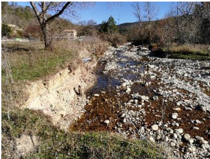
Figure 15: Erosion de berge en rive droite en aval de la Tuilière
