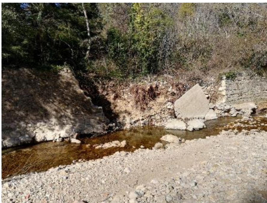
Figure 18: Mur de protection en rive droite sur le secteur de Pré Nouveau
