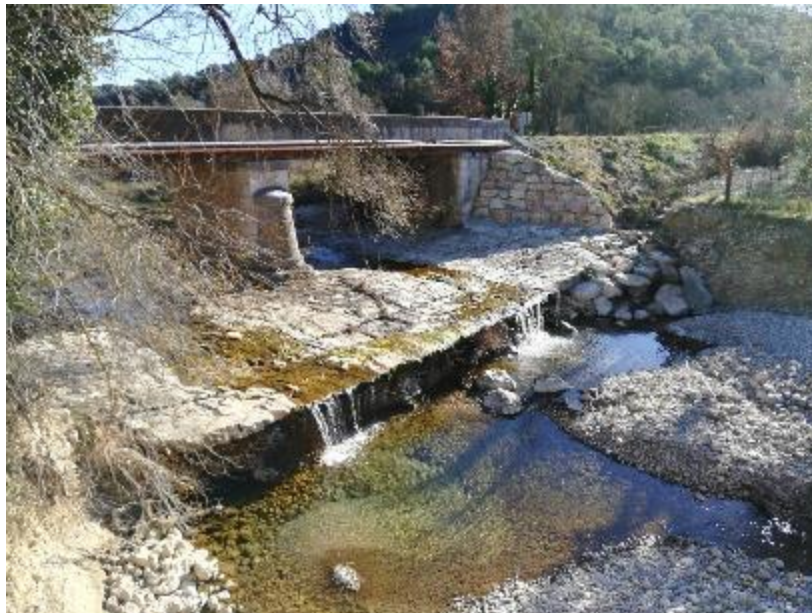
Figure 22: Erosion progressive à l'aval du pont de la RD 51
