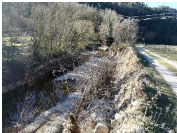
Figure 25: Zone d'érosion en bordure de piste d'accès
