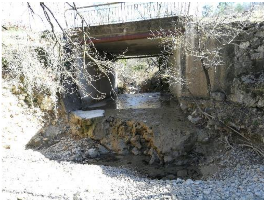
Figure 10: Seuil de stabilisation du pont de la RD955 sur le vallon de la Baume Garnier
