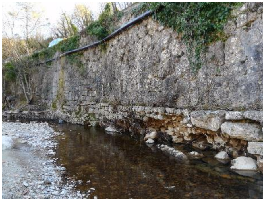
Figure 19: Erosion du pied du mur de protection de la RD 955
