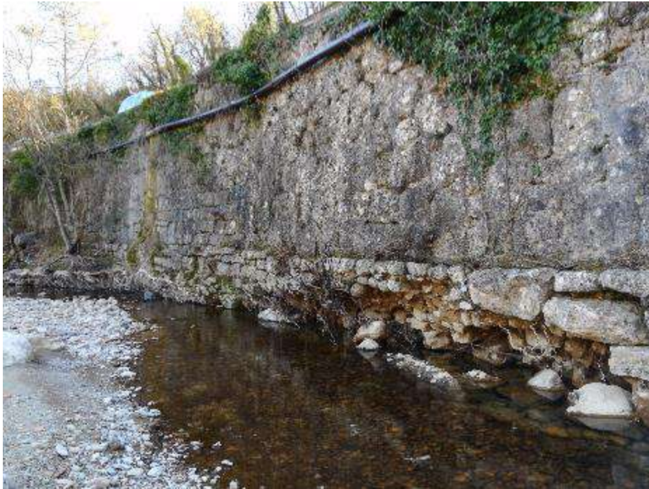
Figure 59: Erosion du pied du mur de protection de la RD 955
