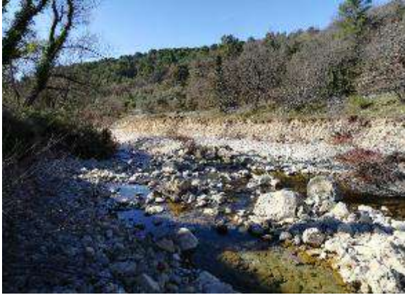
Figure 51: Erosion en rive droite à l'aval de la confluence avec Baume Garnier
