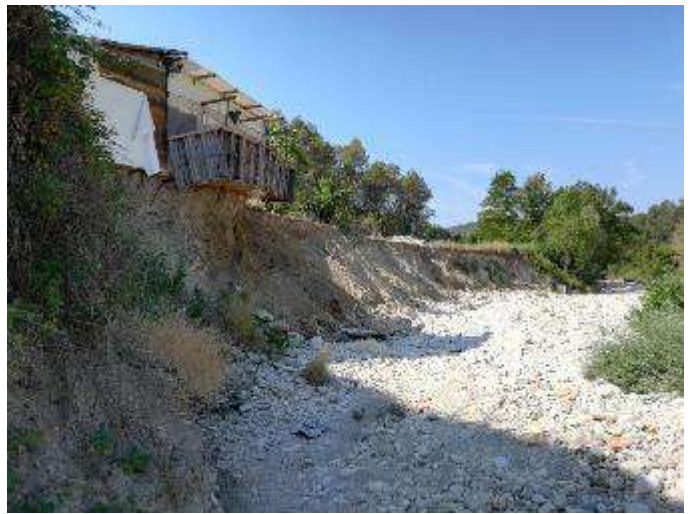
Figure 54: Vue sur la zone d'érosion de la zone de l'ancien snack
