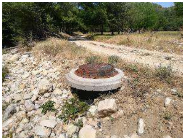
Figure 64: Réseau d'eau usée mis à nu
