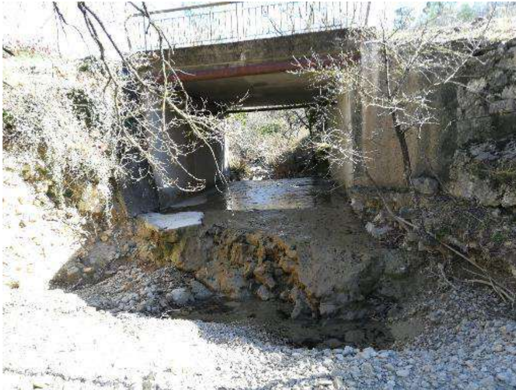
Figure 50: Seuil de stabilisation du pont de la RD955 sur le vallon de la Baume Garnier
