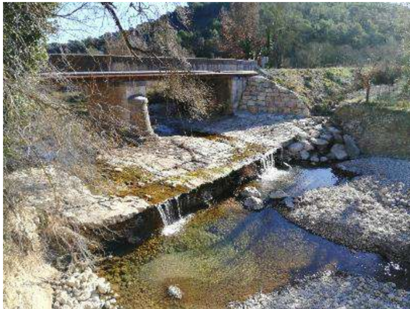
Figure 62: Erosion progressive à l'aval du pont de la RD 51
