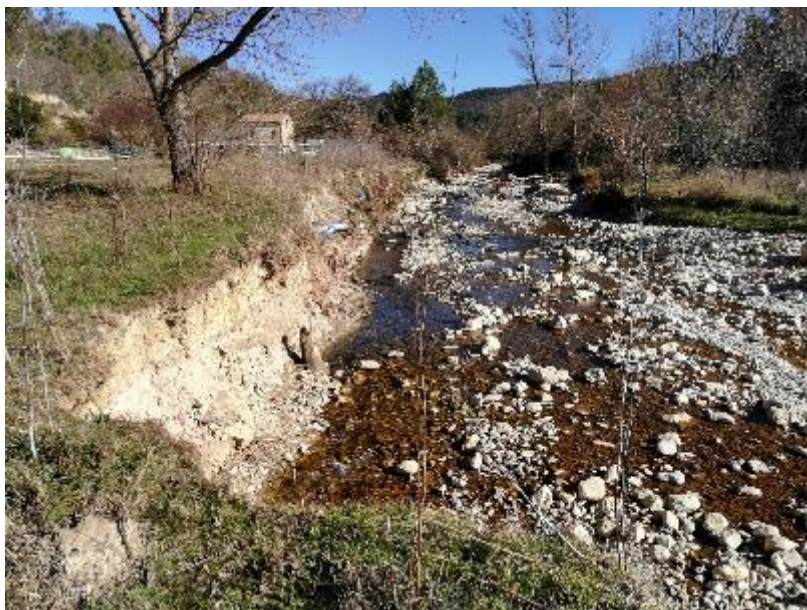
Figure 55: Erosion de berge en rive droite en aval de la Tuilière
