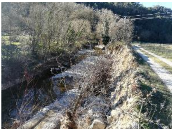
Figure 65: Zone d'érosion en bordure de piste d'accès
