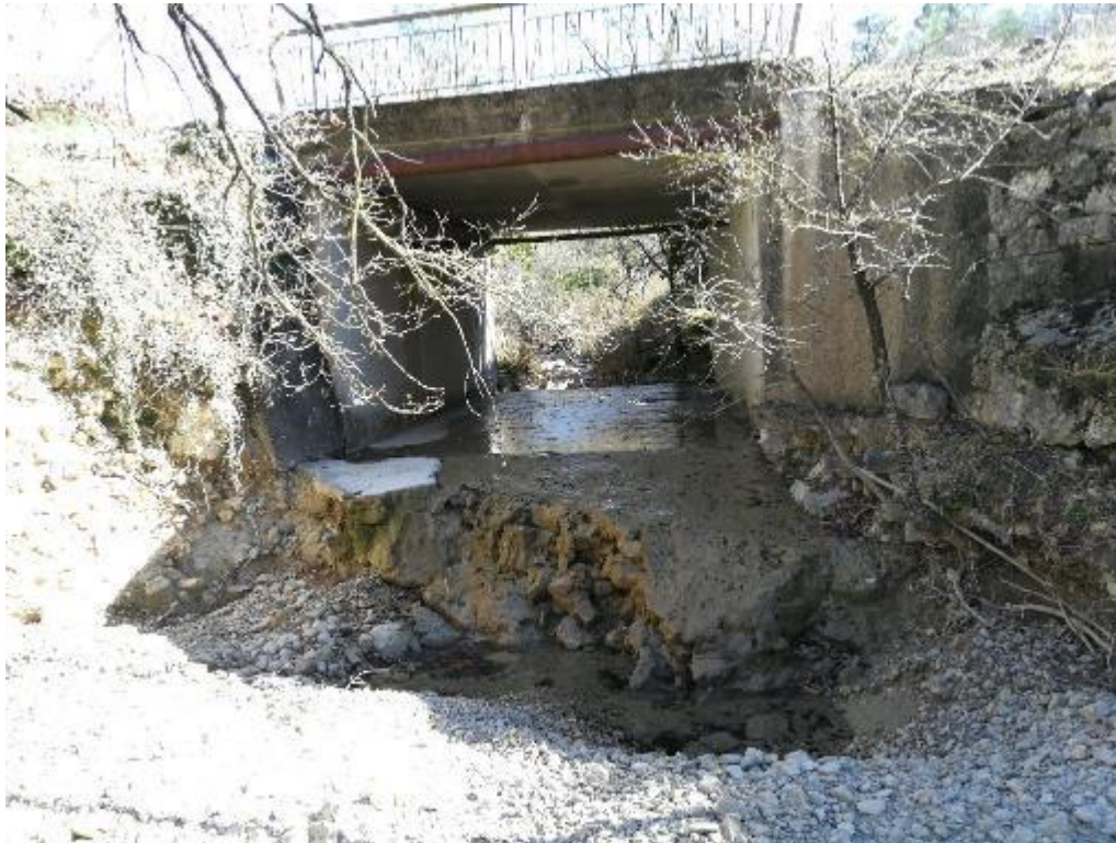
Figure 50: Seuil de stabilisation du pont de la RD955 sur le vallon de la Baume Garnier
