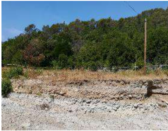
Figure 56: Poteau électrique menacé par l'érosion
