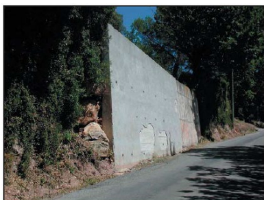
Mur de consolidation contre les glissements sur le chemin du Vieux Cannet
