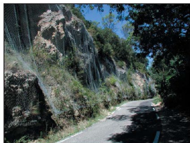
Filets de protection pour prévenir des chutes de blocs (Nord-Est de la commune)
