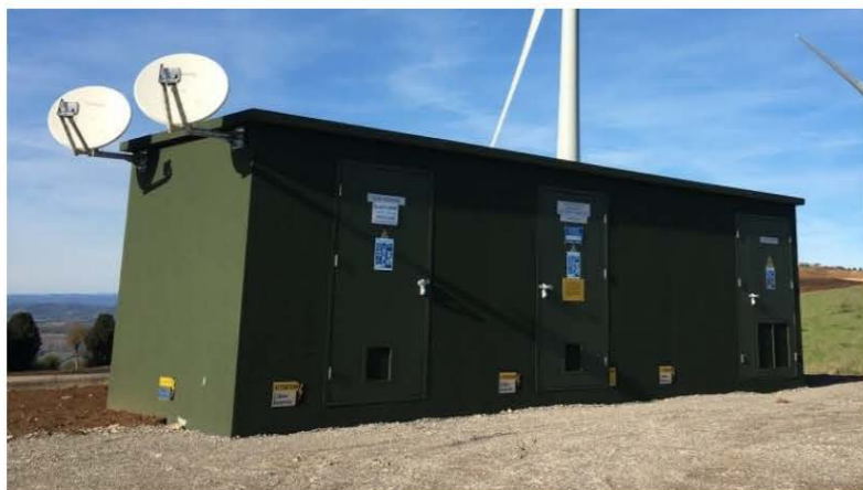
Photo 3 : exemple de poste de livraison électrique sans habillage
