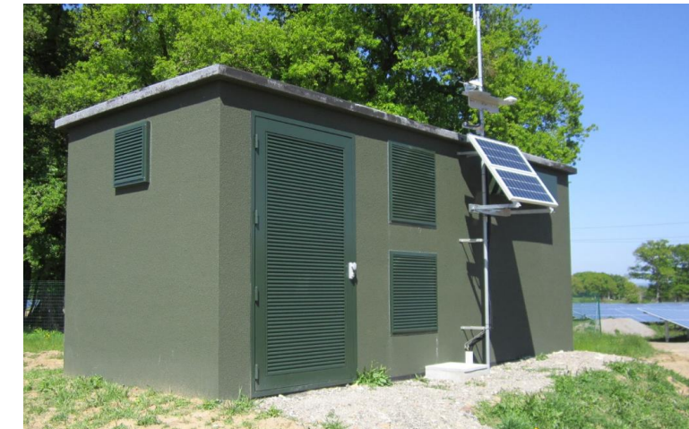
Photographie 56 : Exemple d'un poste de livraison peint en vert (Source : ENCIS Environnement)
