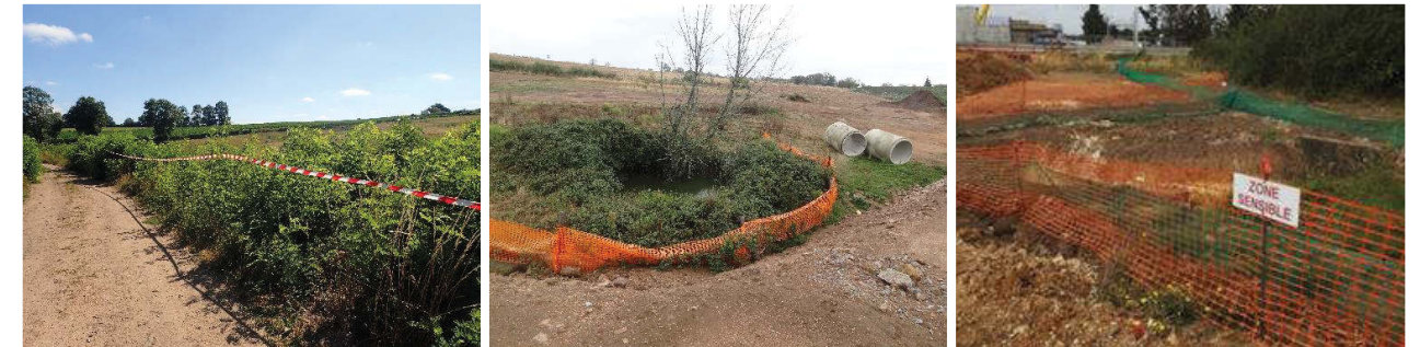
Figure 17. Exemples de mise en défens à éviter (Source Crexeco)
