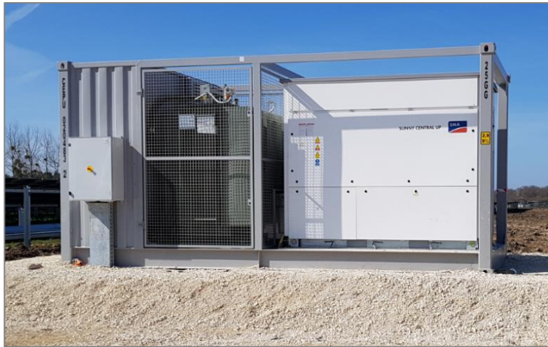
Photographie 40 : Poste transformateur outdoor (Source : Photosol)
