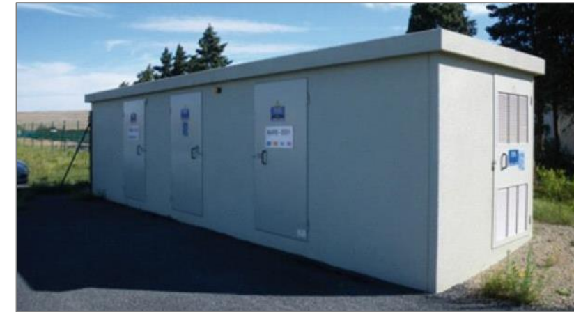
Photographie 41 : Poste de livraison (Source : ENCIS Environnement)
