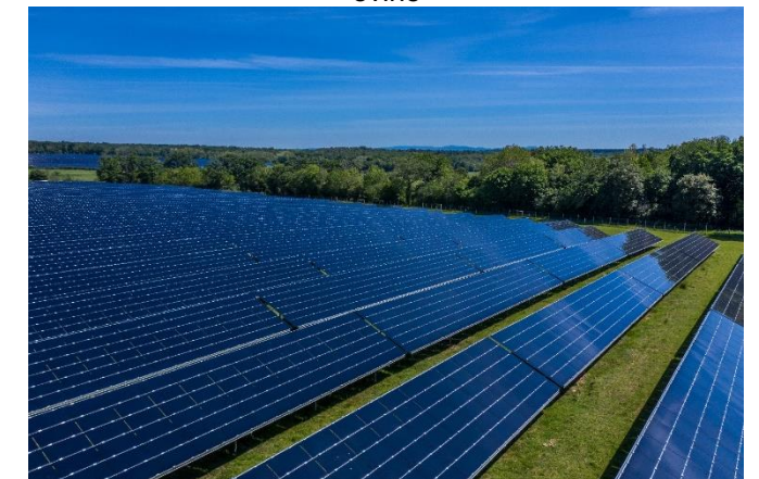
Centrale de Verneuil (58)
