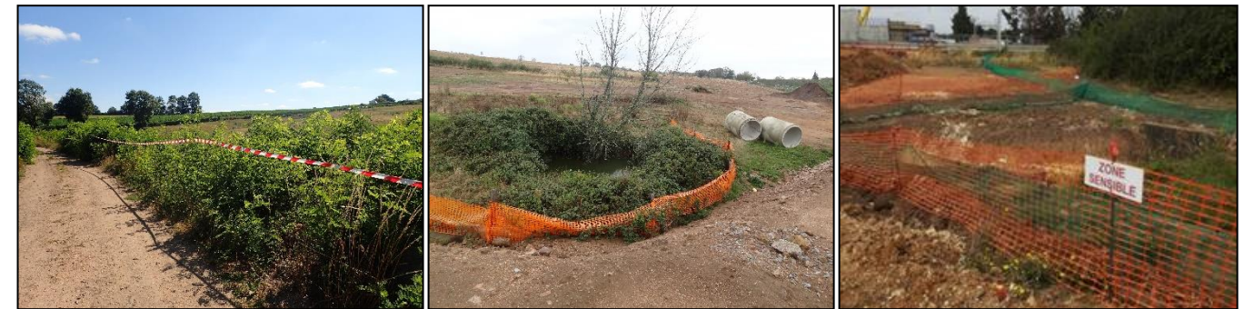
Figure 52 : Exemples de mise en défens à éviter (Source : Crexeco)
