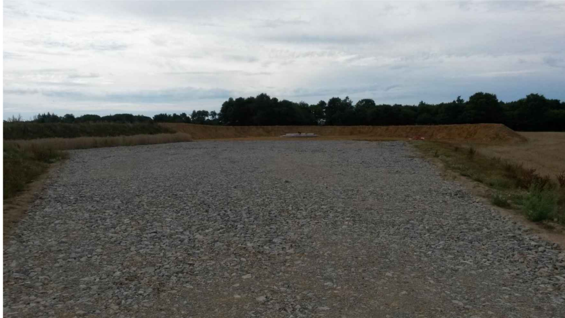
Illustration 137: Exemple de plateforme de grutage
