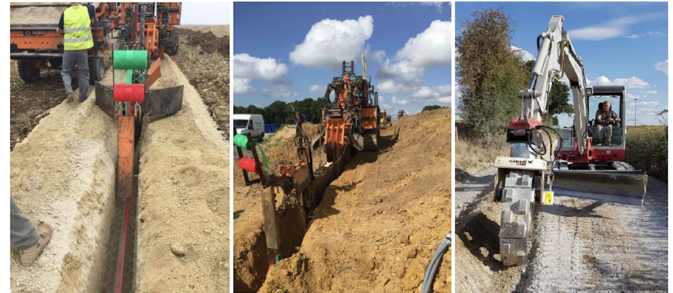
Illustration 185: Photographies d'illustration de travaux de réalisation d'une tranchée en bord de route
