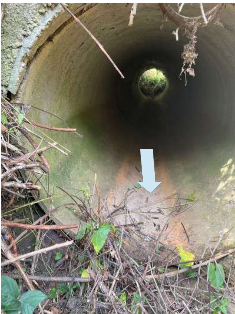
Vue de la conduite en DN 800 mm
