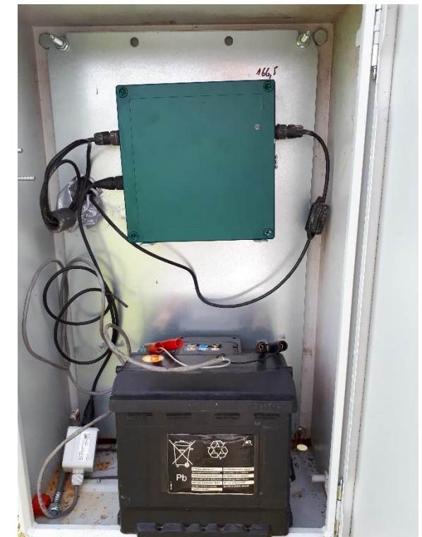
Photographie 5. Coffret électrique avec SM2BAT+ installé - prise dans le secteur d'étude
