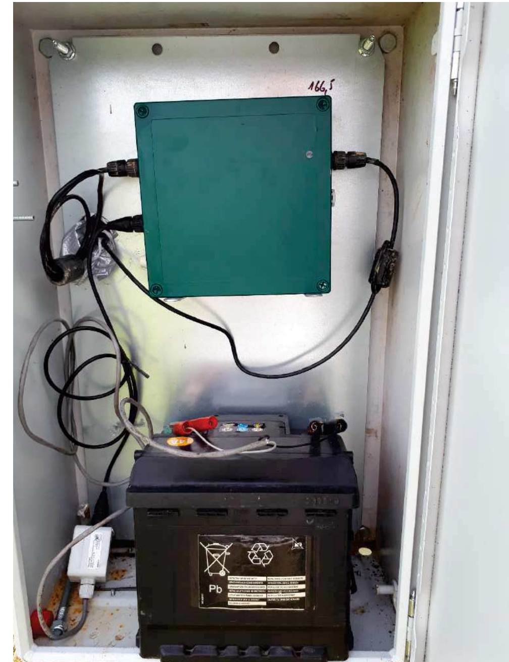
Photographie 9. Raccordements des appareils dans le caisson étanche
