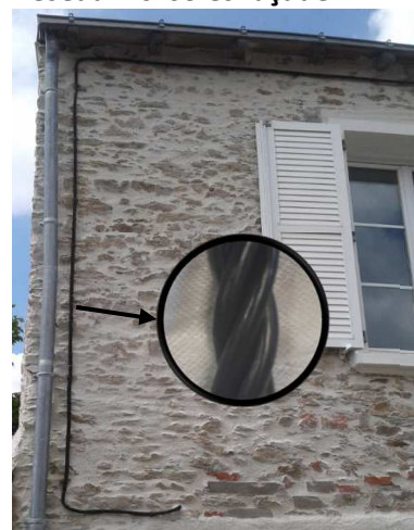
Réseau fils isolés façade BT
