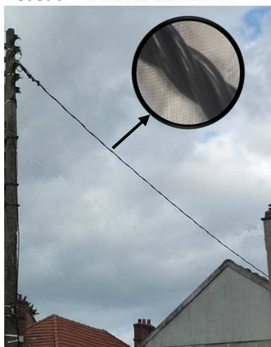
Réseau fils isolés aérien BT
