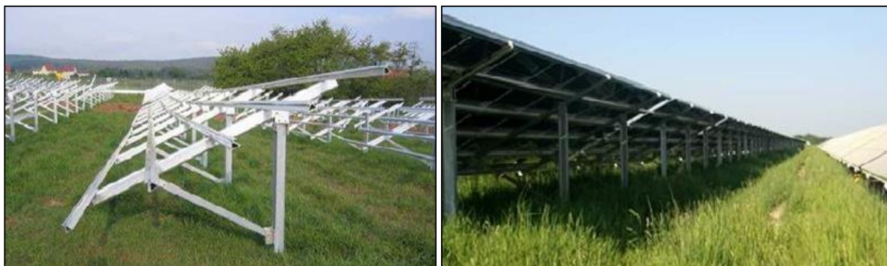
Photo 46 : Structures métalliques avant et après installation des modules photovoltaïques (Source : BE Jacquel et Chatillon)
