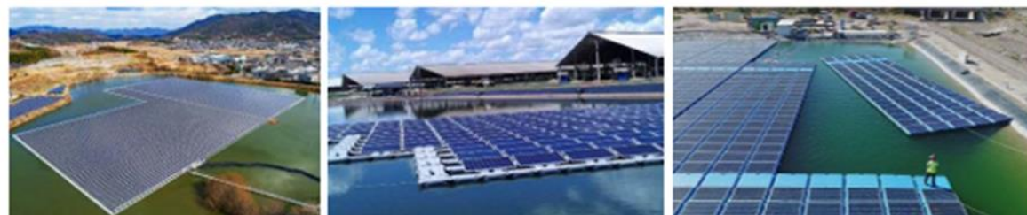
Photo 4 : Illustration de centrales photovoltaïques flottantes (Source : Ciel et Terre International et Isifloating)
