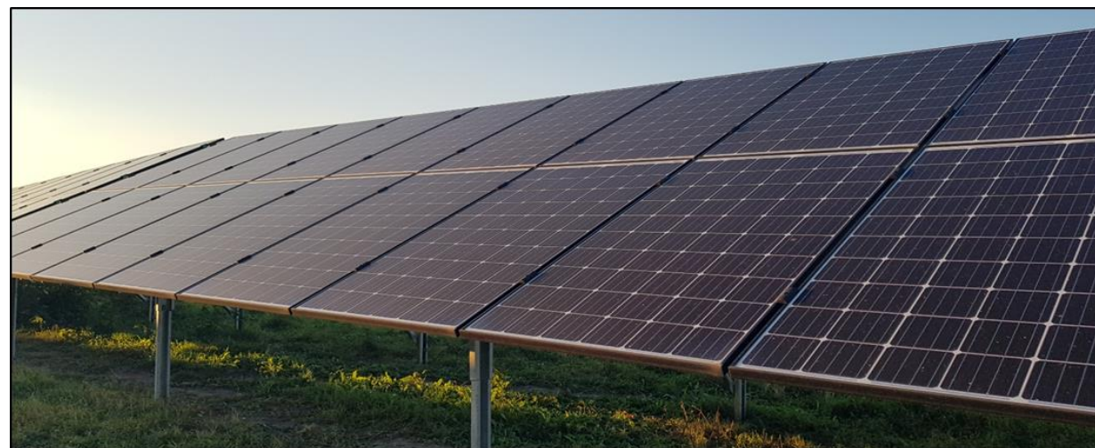
Photo 48 : Rangées de modules photovoltaïques (Source : BE Jacquél et Chatillon)
