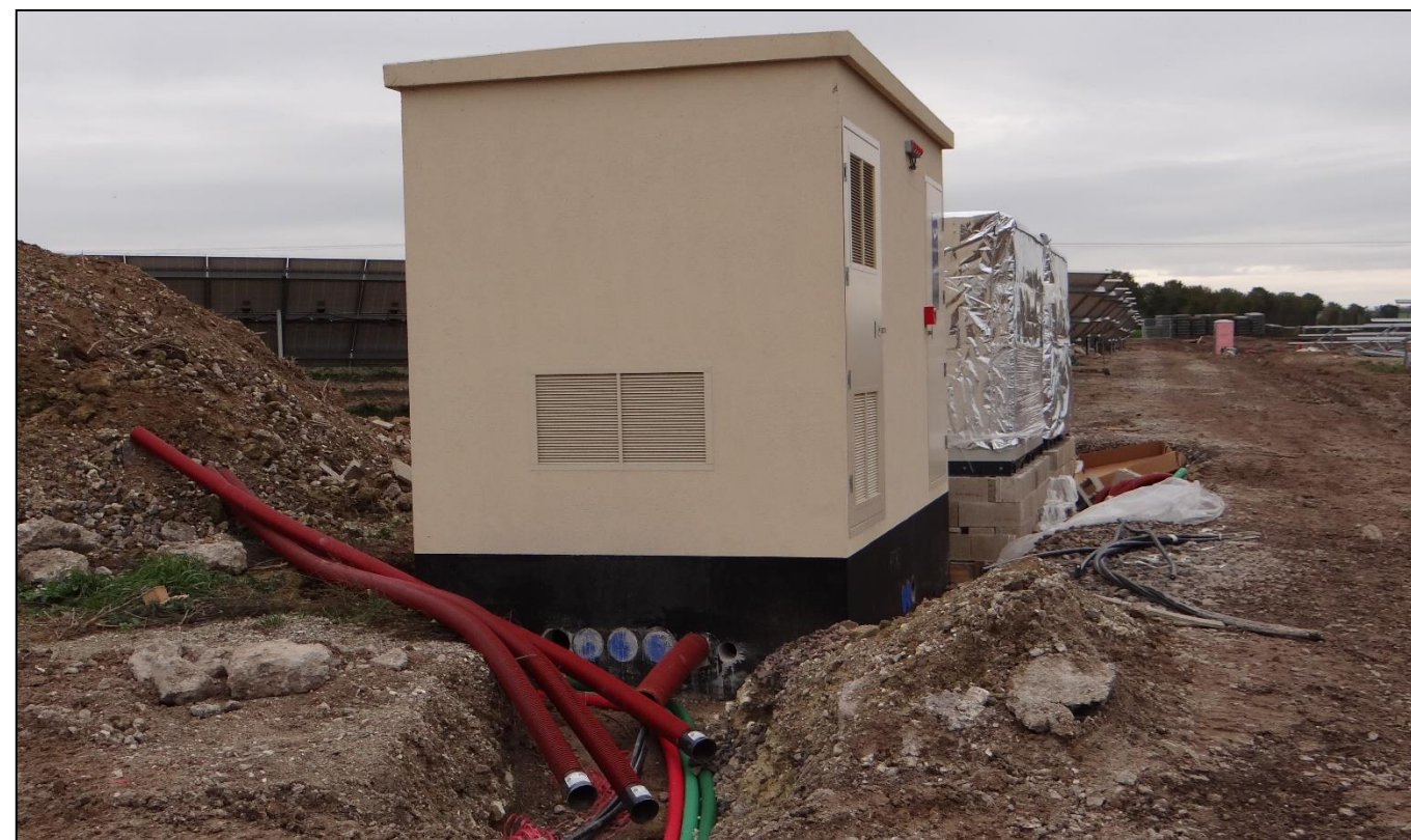
Photo 50 : Installation et raccordement d'un poste de transformation (Source : BE Jacquel et Chatillon)
