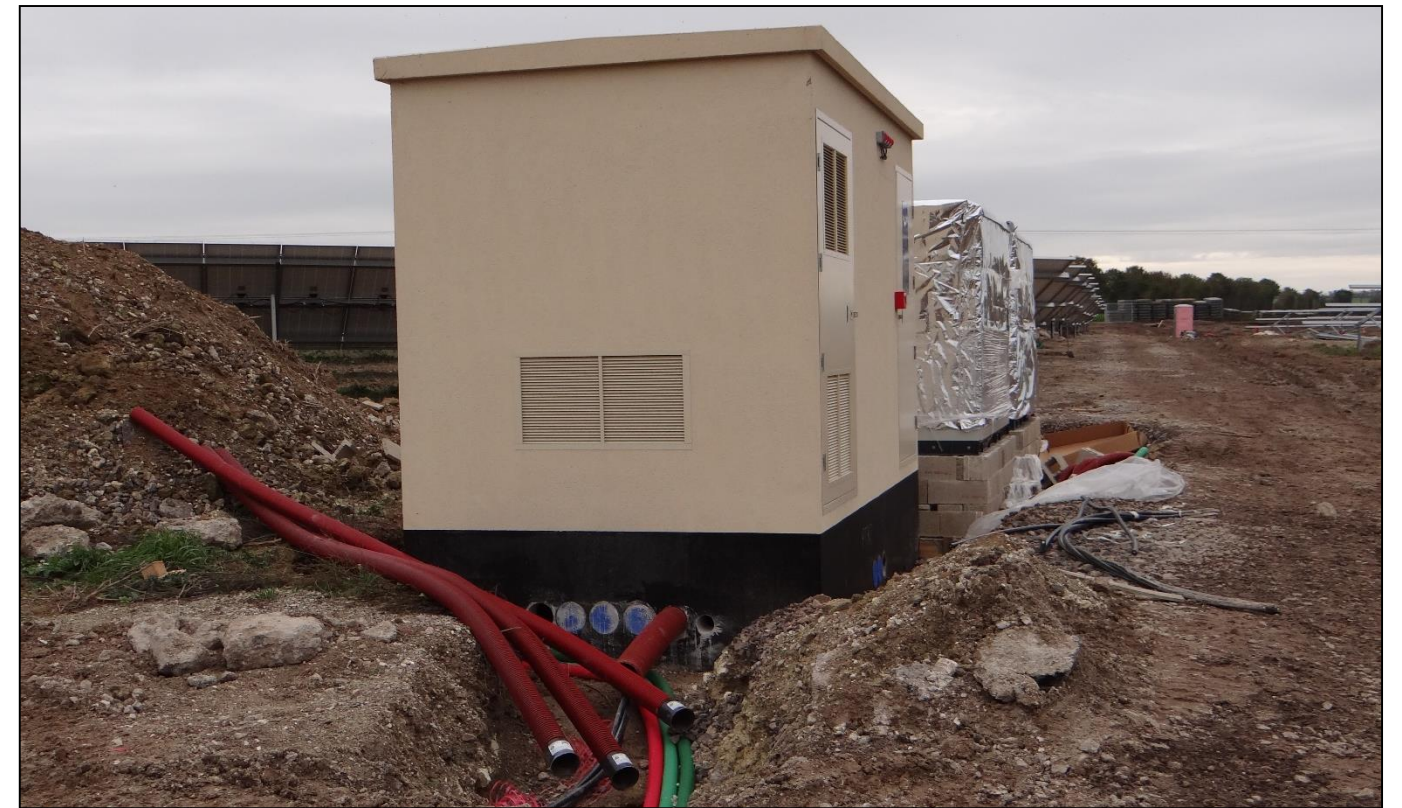
Photo 53 : Installation et raccordement d'un poste de transformation (Source : BE Jacquel et Chatillon)
