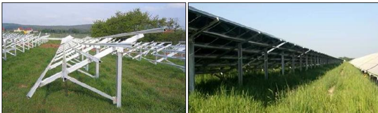
Photo 49 : Structures métalliques avant et après installation des modules photovoltaïques (Source : BE Jacquiel et Chatillon)
