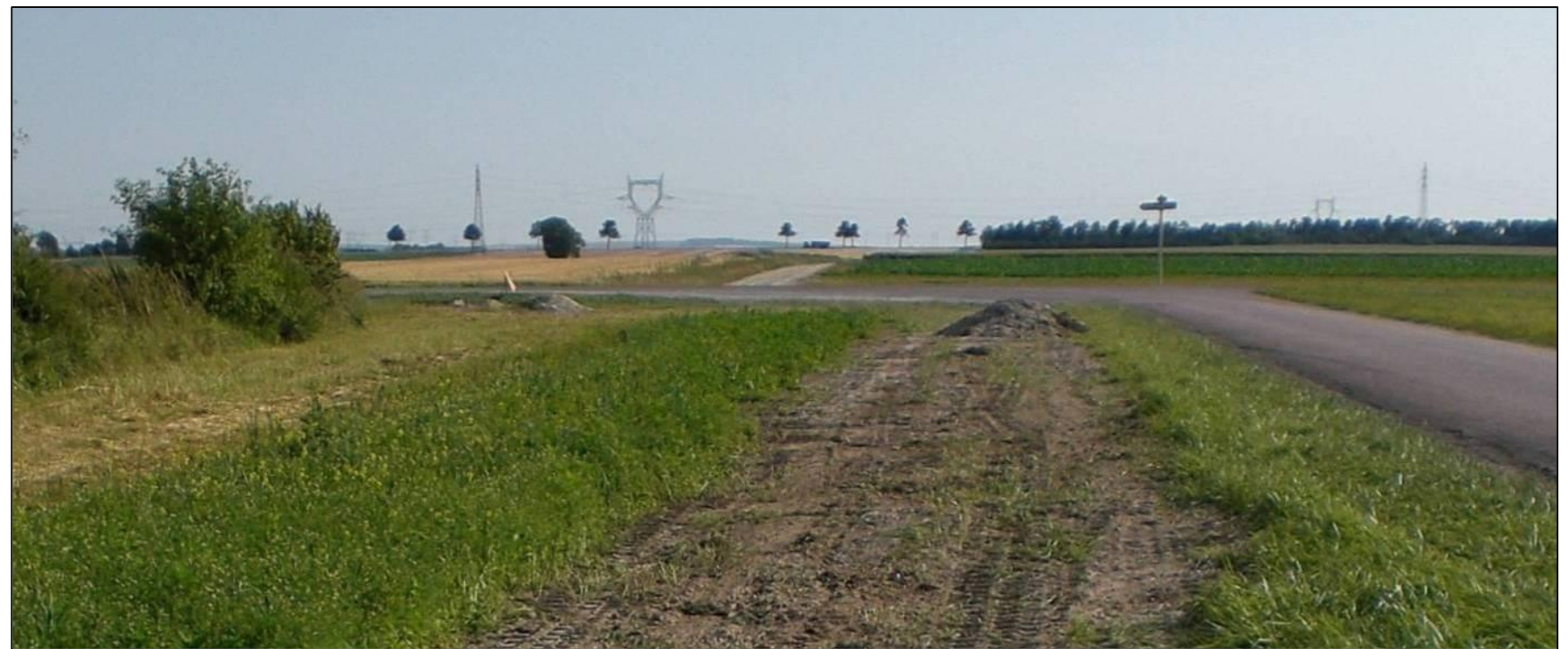
Photo 66 : Rebouchage de tranchée après passage des câbles électriques (Source : BE Jacquiel et Chatillon)
