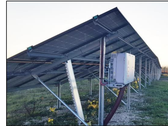
Photo 52 : Onduleur fixé à l'arrière des tables (Source : BE Jacquel et Chatillon)
