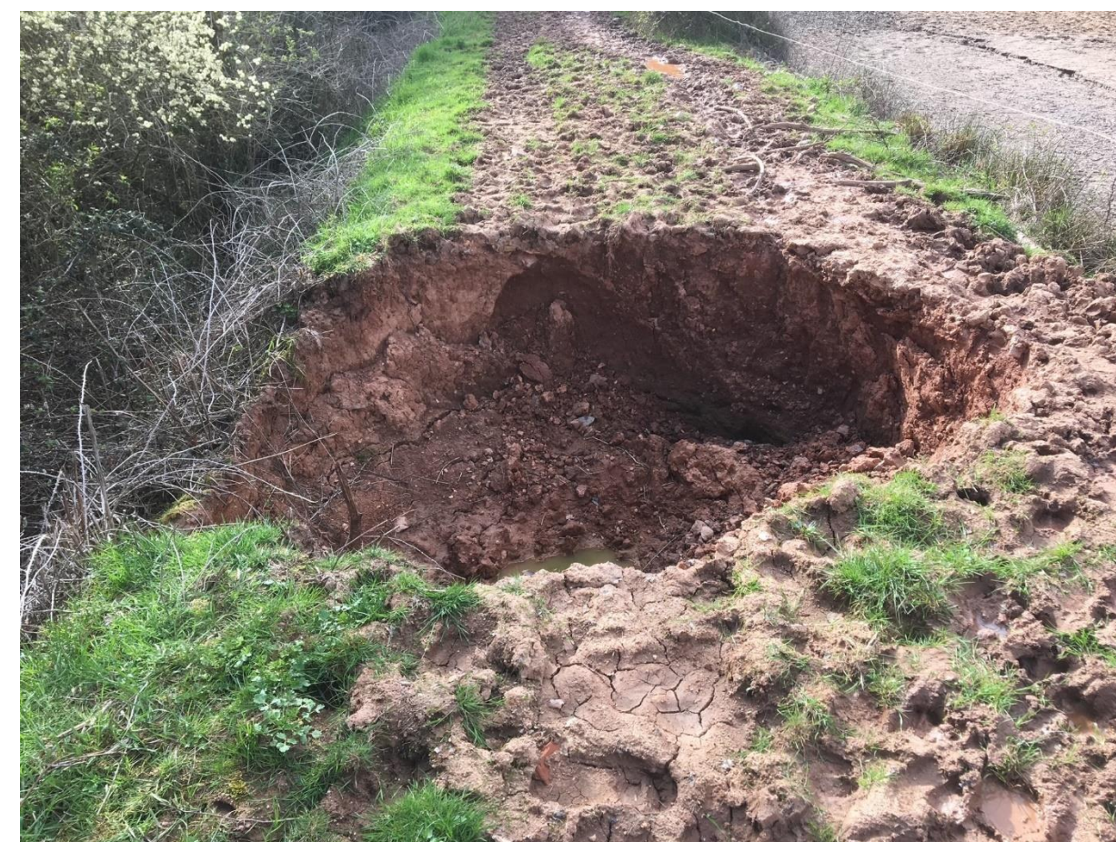
Figure 3 : Photo C - Visuel de la digue d'étang à traverser pour l'accès à la parcelle n° AT 139 (digue détériorée par l'érosion, réparée depuis mais fragile) (source : M. Kronenberg, 2023)
