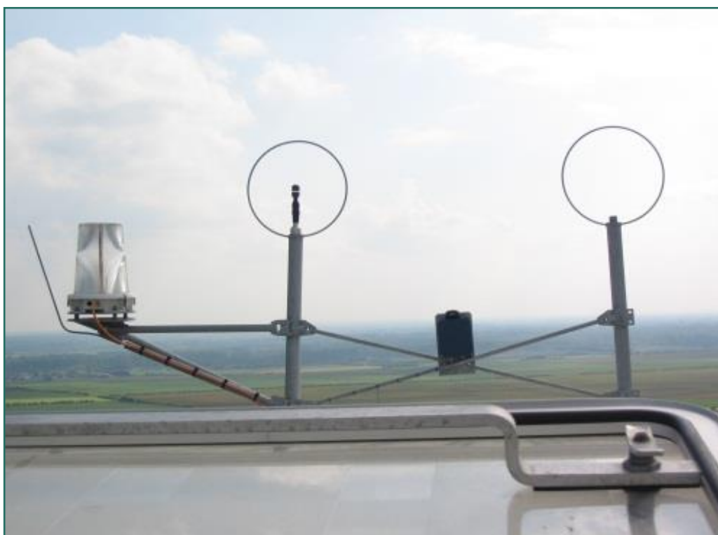
Figure 10 : Photographie d'un exemple de balisage aéronautique
