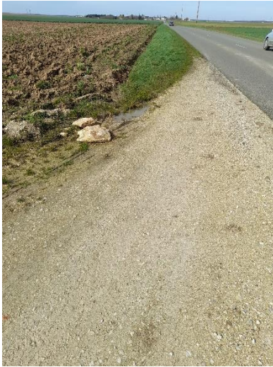
Figure 3 : Chemin rural aménagé pour le parc éolien du Canton de Bonneval (repères A et C à D, source : Volkswind)
