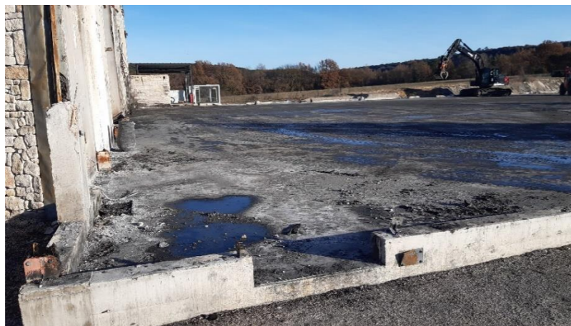
Bâtiment administratif du Laboratoire Gravier intacte (en haut) et la partie stockage et laboratoire de production sinistrés (en bas) - Source : Bureau Veritas
