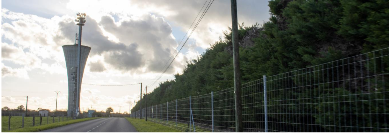
Photo 16. Antenne relais Bouygues Telecom (pylône tubulaire) : faisceaux hertziens, depuis la D60
