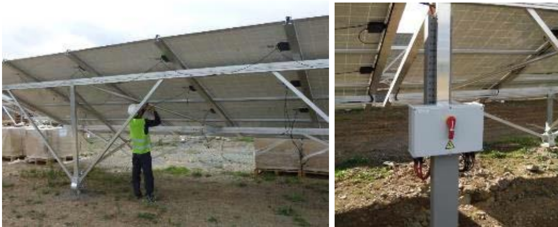
Photo 37. A gauche : câblage des panneaux – A droite : boîtier de raccordement
