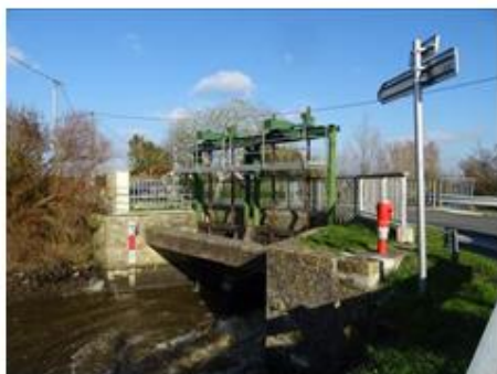
Ecluse au-dessus du Falleron - Limite départementale entre Bois-de-Cené et Villeneuve-en-Retz et Machecoul
