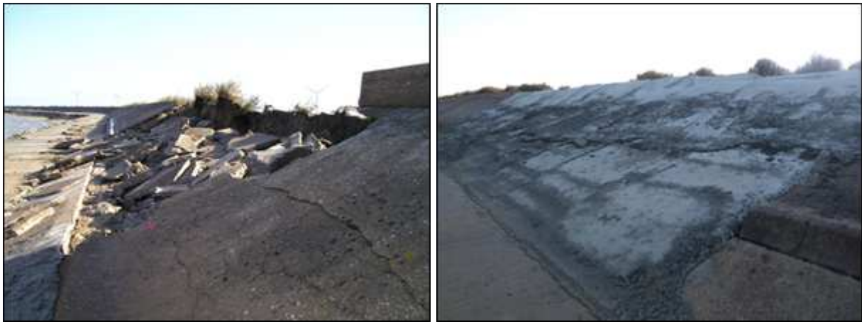
Figure 3-20 : illustration des destructions et réparations d'urgence post-Xynthia.
