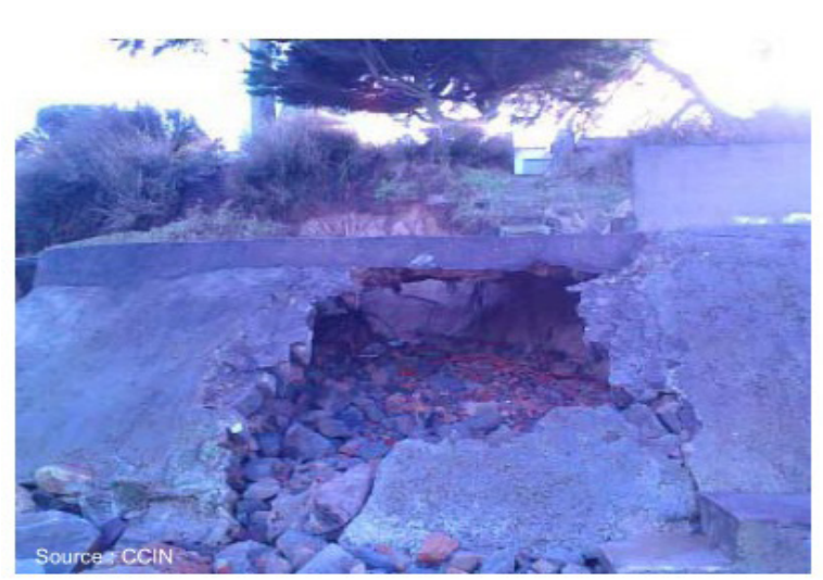
Risque lié à la défaillance du système de protection contre les inondations
