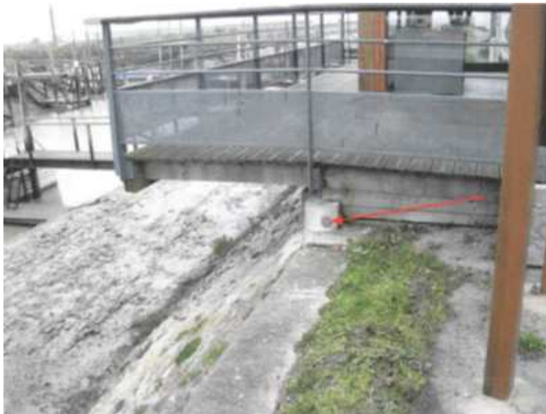
Figure 2-2 : extrait de la fiche de repère et photo de l'un des repères de niveau au Port du Collet.
