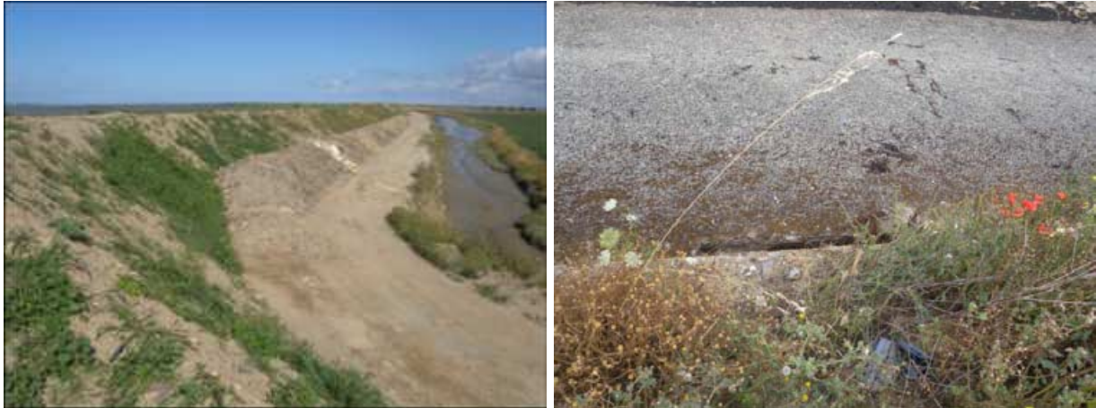
Figure 3-15 : digue des Glagées – surélévation à gauche ; dégradations à la transition béton-maçonneries côté mer.
