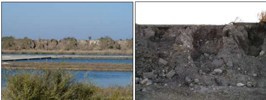
Figure 3-17 : érosion du talus aval de la digue de la Louippe – vue générale et détail.
