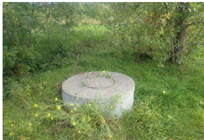
Ouvrage inconnu sur l'alvéole n°1* : probablement un regard de visite, non référencé dans le cadre du suivi environnemental
