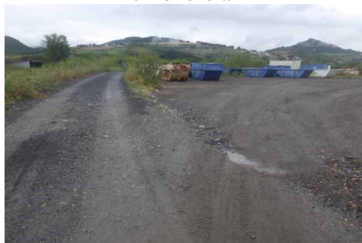
Vue de la piste d'accès Praxy sur le site, en direction du Nord. Piste principale vers le Nord du site et piste vers une plateforme sur l'alvéole n°1
