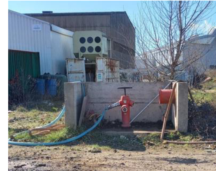
Figure 28 - Borne incendie existante au Nord du site de Praxy
