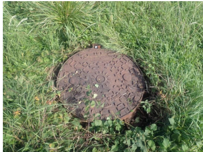
Regard de visite casier n°3*
