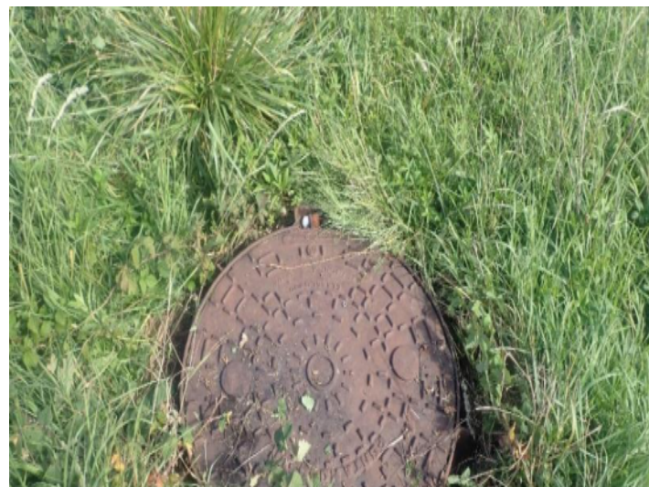
Regard de visite casier n°3*
