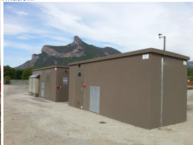
Photographie 7. Un poste de livraison et un poste de transformation
