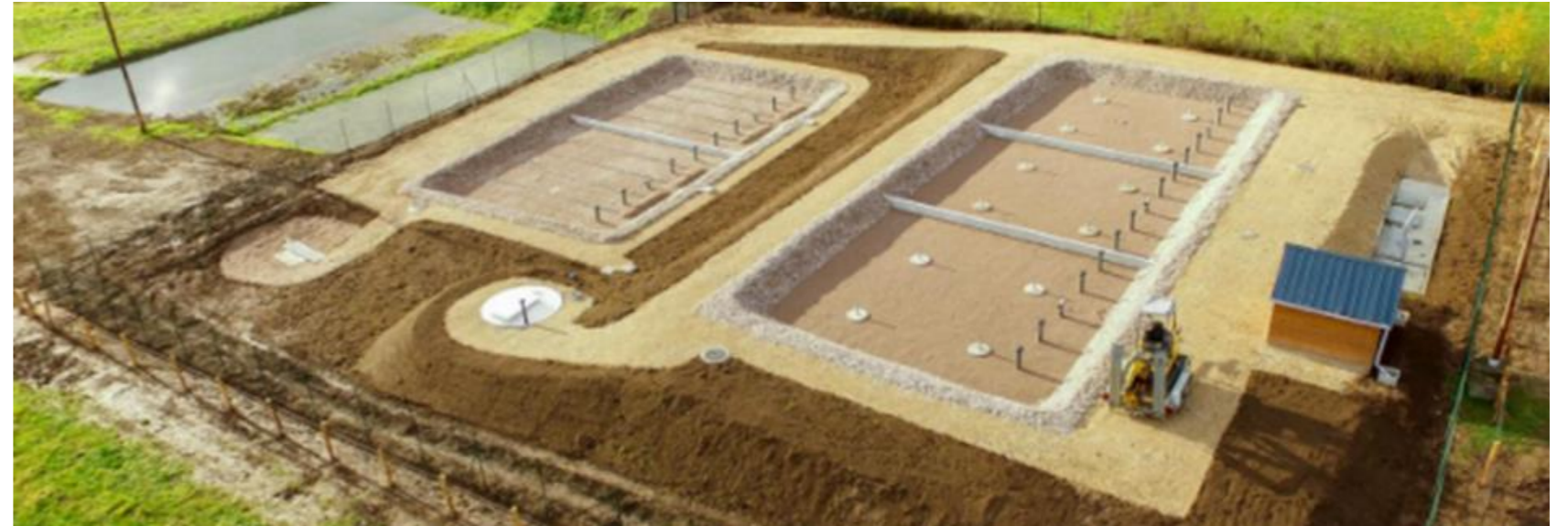
Figure 1 : Exemple d'une construction d'une STEP en filtres plantés de roseaux, avant plantation des roseaux
