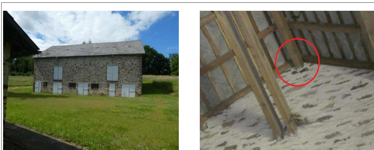
Illustration 78 : Etable du hameau de la porte abritant au moins 23 individus de Sérotine commune en gîte de mise bas (source : Oxalis SCOP)
