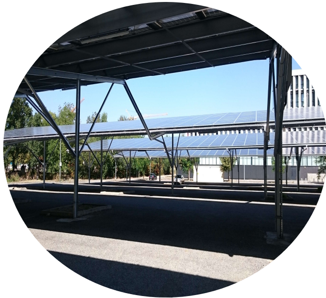
Vue d'une installation d'ombrières photovoltaïques de parking
