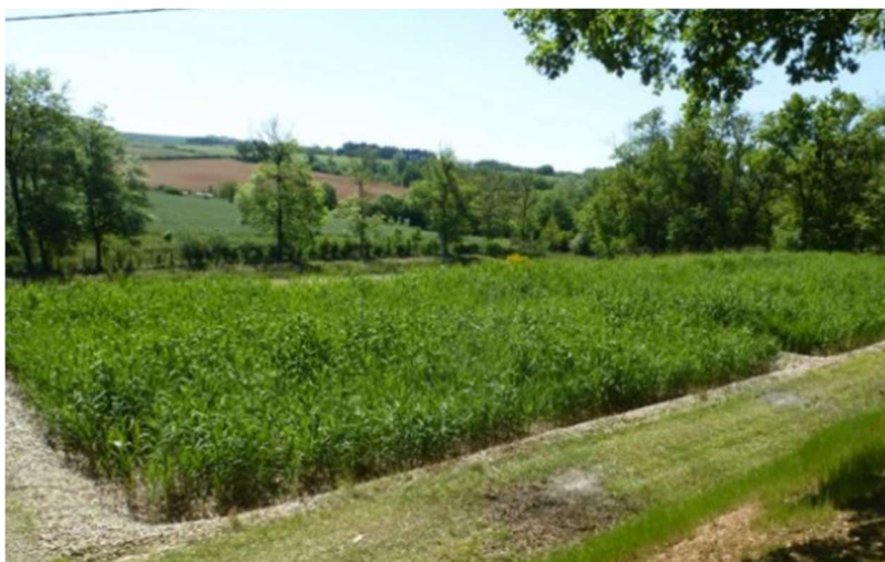
Figure 11: Exemple d'installation de STEP après développement des roseaux
