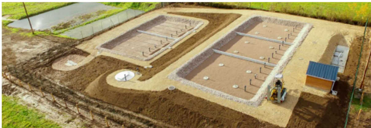
Figure 1: Exemple d'une construction d'une STEP en filtres plantés de roseaux, avant plantation des roseaux
