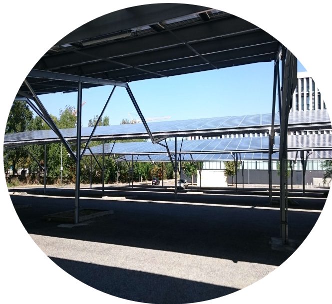
Vue d'une installation d'ombrières photovoltaïques de parking
