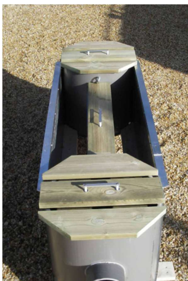
Figure 14: Exemple d'ouvrage de comptage - canal Venturi
