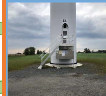
Plateforme et pied d'éolienne entretenu
