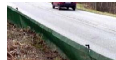
Exemple de barrière anti-intrusion
