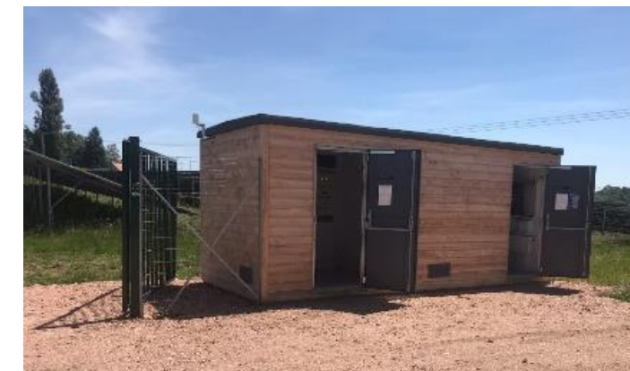
Figure 298 : Exemple de la mesure d'insertion paysagère d'un poste de livraison (source : Cévennes Energy)
