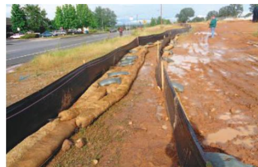
Double barrière de rétention installée à la périphérie de l'emprise du chantier et conjuguées à des boudins en fibres de paille maintenus au sol par des sacs de graviers
