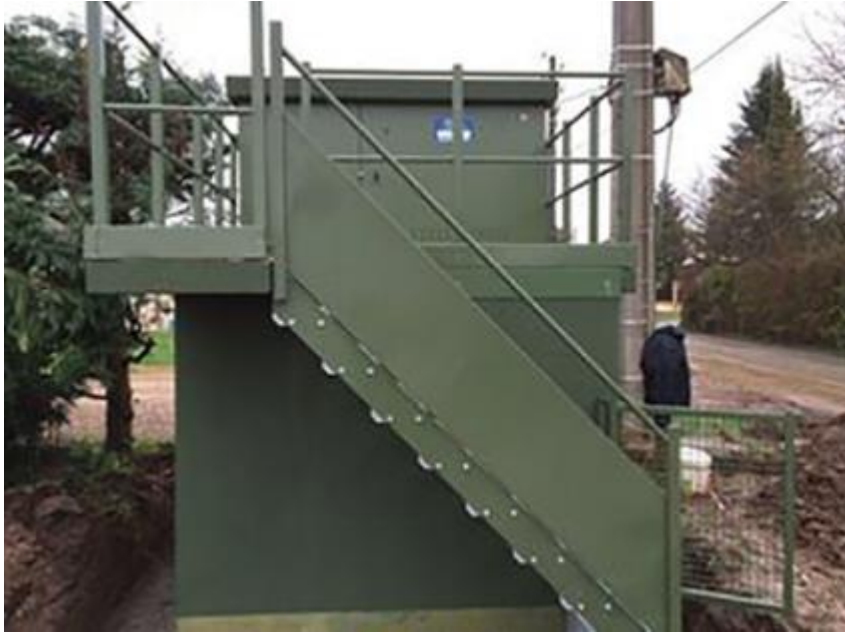
Figure 35 : Exemple de poste de transformation et de livraison HTA/BT réhaussé (rehausse pssa, s.d.)
