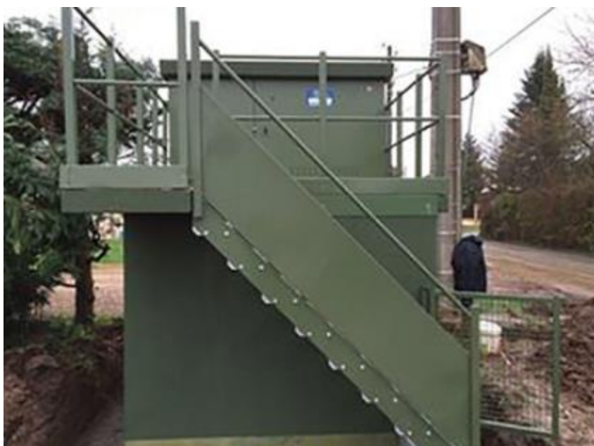
Figure 9 : Exemple de poste de transformation et de livraison HTA/BT réhaussé (rehausse pssa, s.d.)
