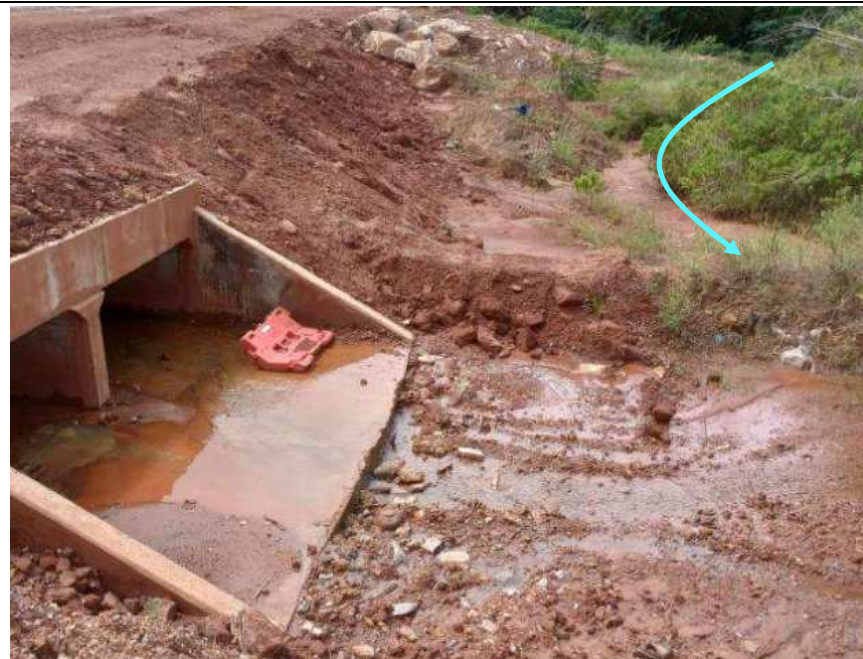
Secteur 2 : arrivée de l'exutoire du BV B10 en sortie de l'OH BHNS
