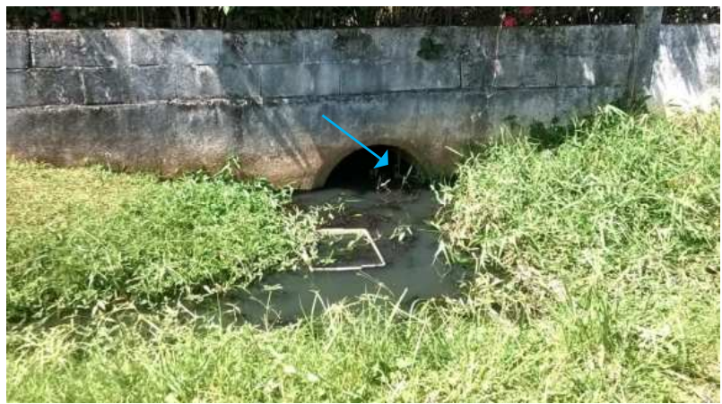
Photo 2 Rue d'Amarante Les écoulements venant de la buse sont bloqués par la route
