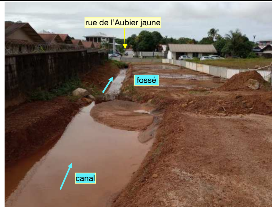
Secteur 4 : arrivée du canal dans le fossé qui longe le terrain de foot puis canalisé dans une buse 800 sous la rue de l'Aubier jaune
