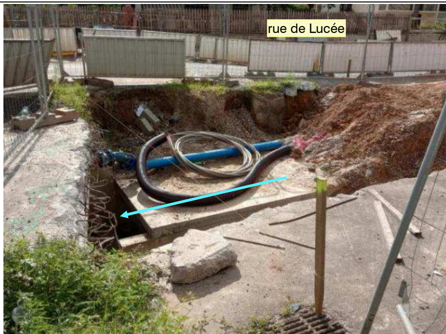
Secteur 3 : vue de la fin du cadre pluvial de la rue de Lucée raccordement au cadre existant sous la route du Tigre
