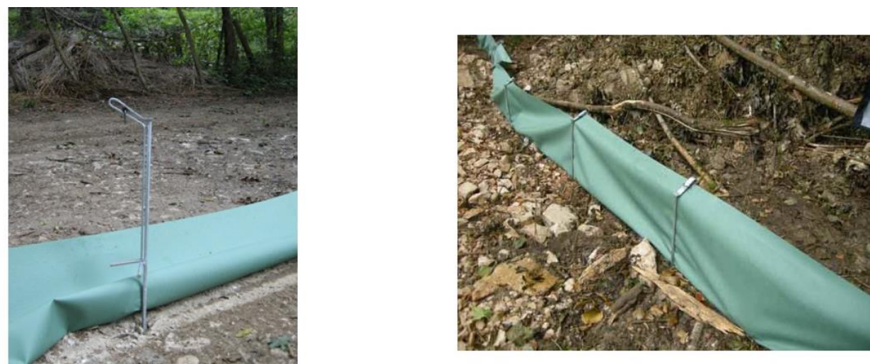
Figure 22 : Exemple d'une barrière avec bavolet et bâche lisse en cours de montage © M. Gigleux, Cerema Est
