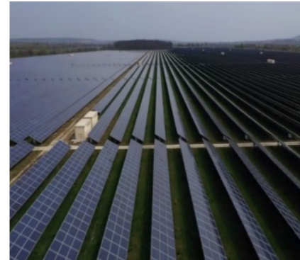
Photographie du parc photovoltaïque "Karad" - Bulgarie
