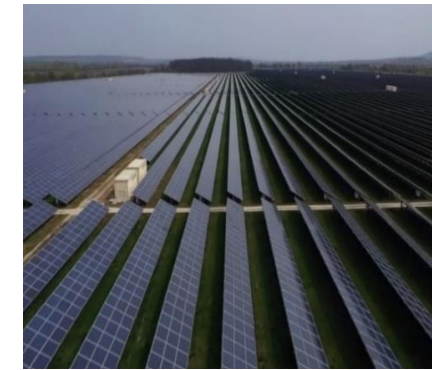
Photographie du parc photovoltaïque "Karad" - Bulgarie
