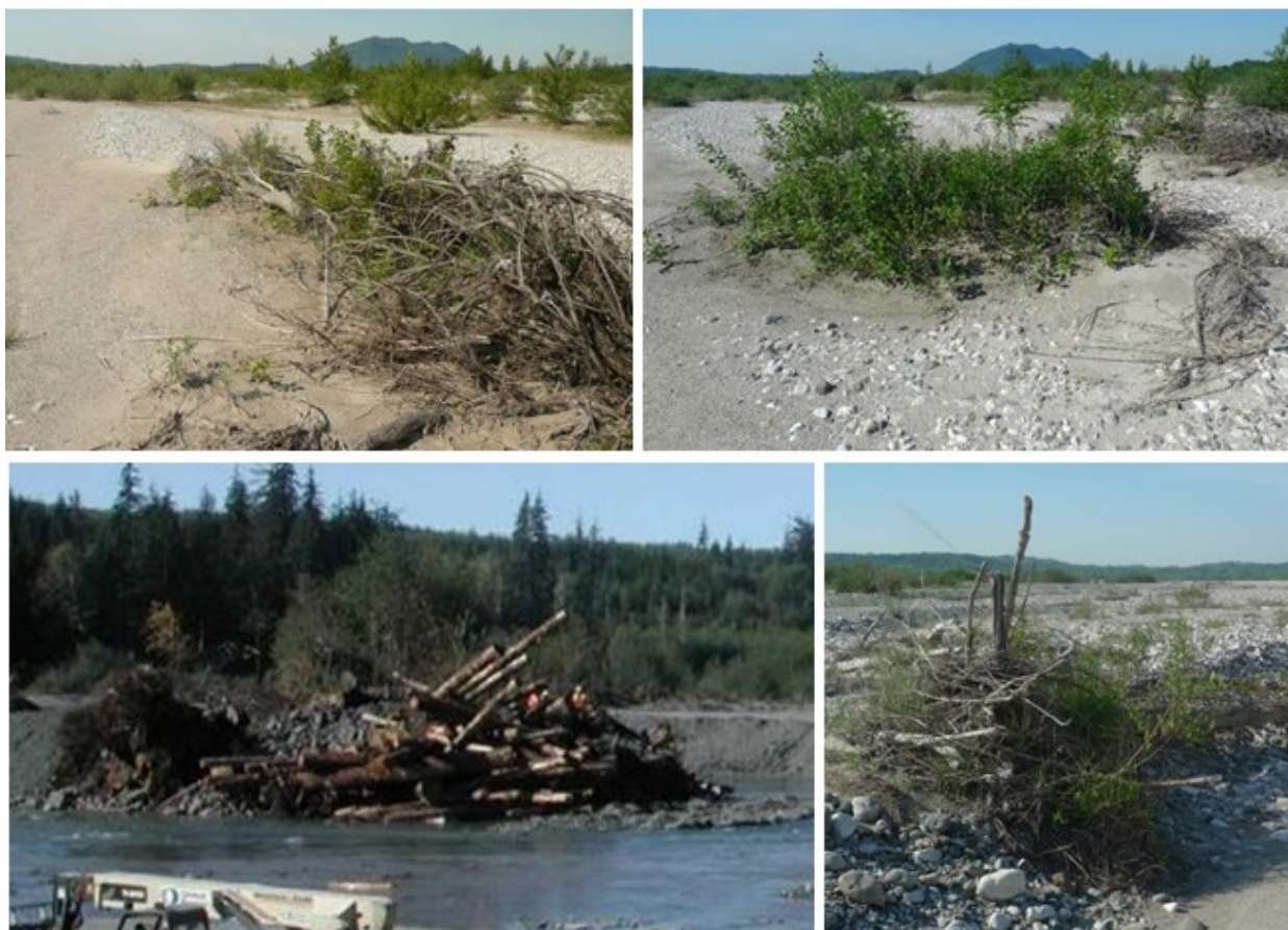
Différentes vues de dépôts végétalisés ou « renforcés » par des structures souples de diversification des conditions d'écoulement : amas de souches et leurs rejets, massifs de pieux de salicacées, structures de troncs enchevêtrés et bois morts (photos Biotec).
