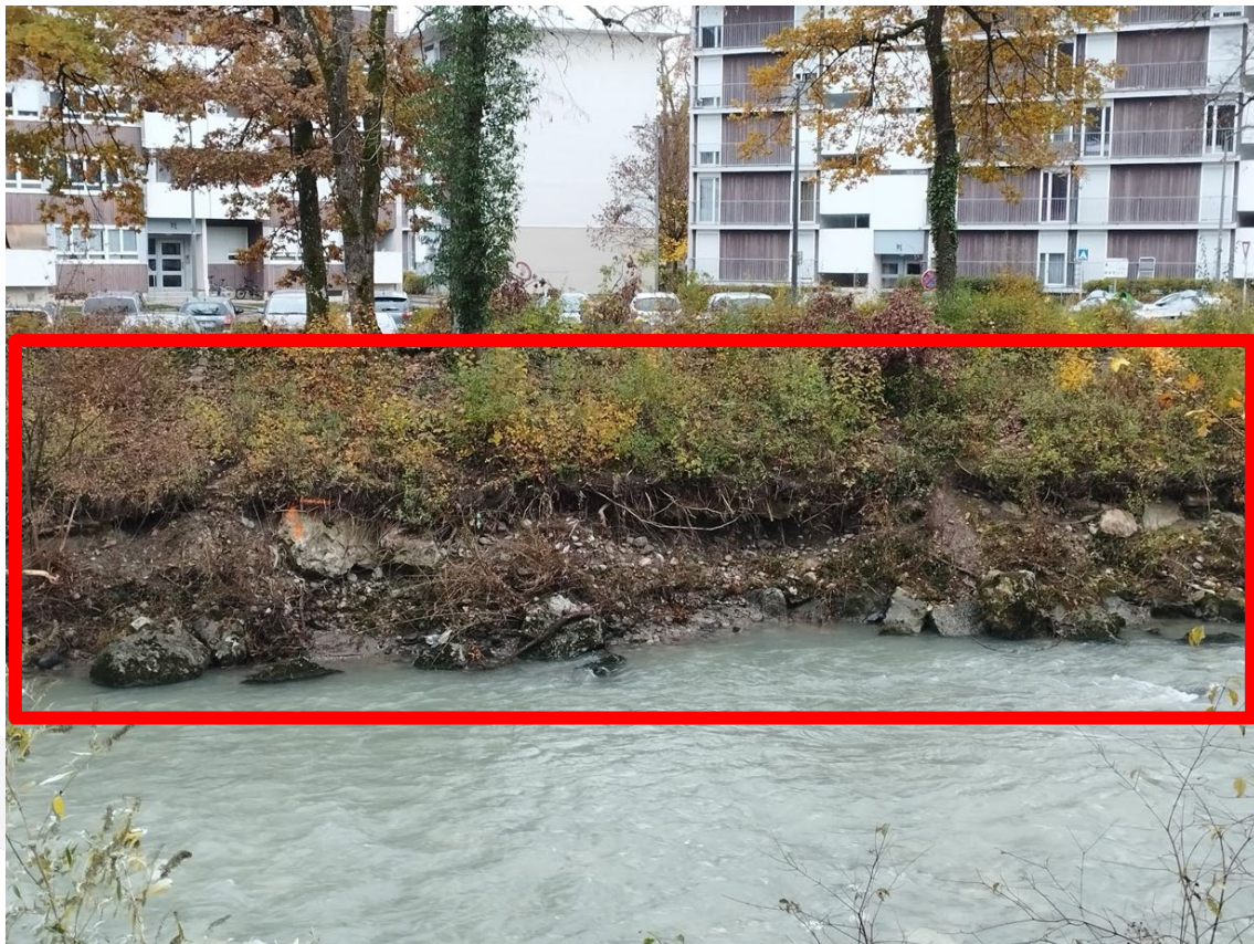
Figure 4 : Illustration des désordres occasionnés sur la digue située en rive droite du BORNE au droit du quartier du Bois Jolivet (BORNE) post crue du 15 novembre 2023
