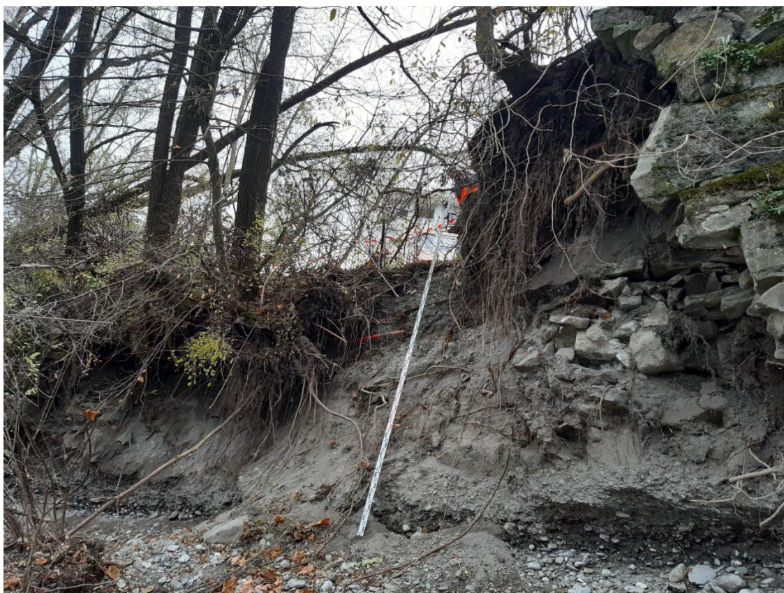
Figure 5 : Illustration des désordres occasionnés sur les digues de l'Arve en amont de la confluence avec le Borne (ARVE) post crue du 15 novembre 2023
