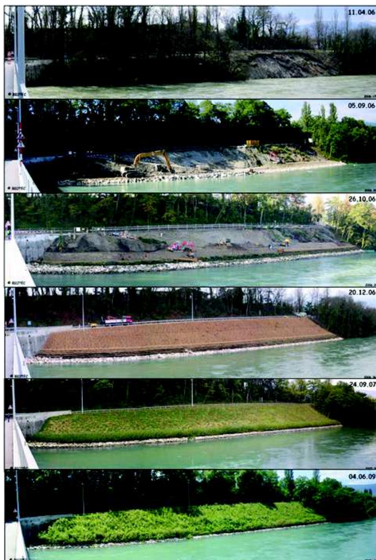
Figure 177 : Illustrations successives de la protection mixte enrochements-lits de plants et plançons-plantation mise en place en rive gauche du Rhône à Avully (Suisse) en soutènement d'une route (conception, photos et suivi des travaux : Biotec en collaboration avec GEOS)
