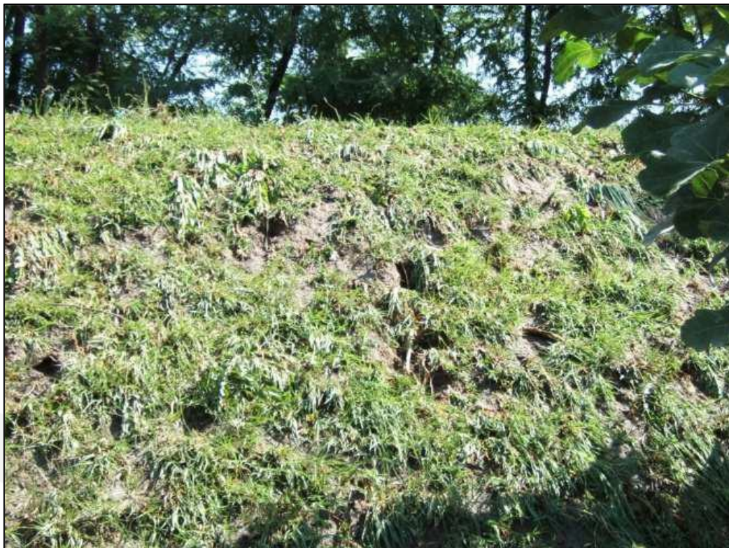
Figure 81 : Début de renard hydraulique RG en amont de la brèche
