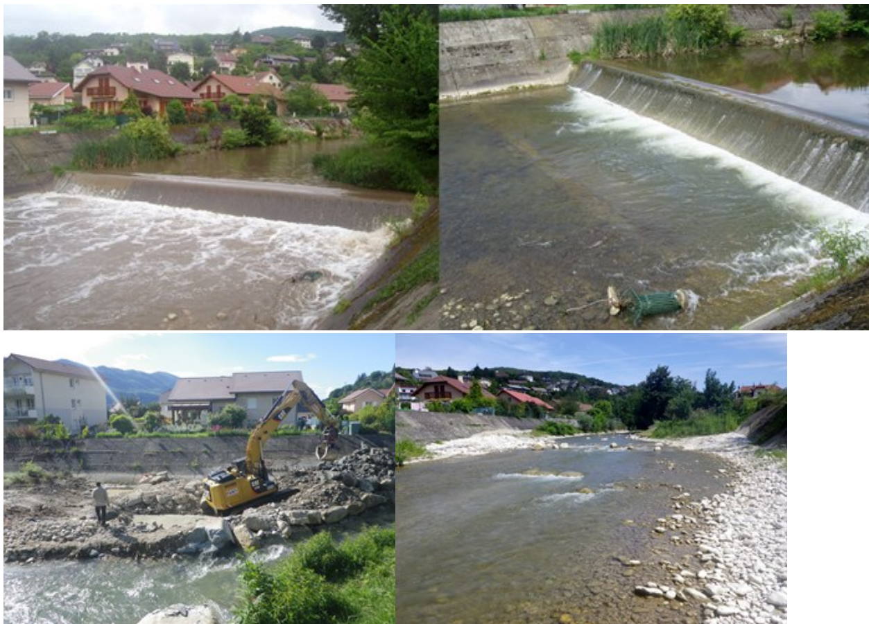
Figure 19 : Illustration d'un seuil infranchissable sur le Sierroz à Aix-Les-Bains, puis de sa démolition et la constitution d'une rampe de stabilisation du profil en long ; conception, photos et maîtrise d'œuvre Biotec
