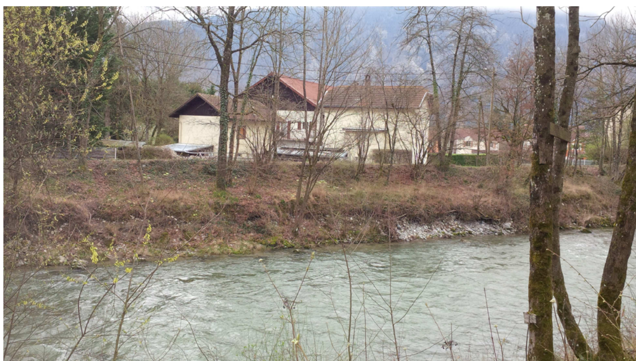
Photos n°4 et 5 – Erosion linéaire le long du pied de berge/digue du Borne
