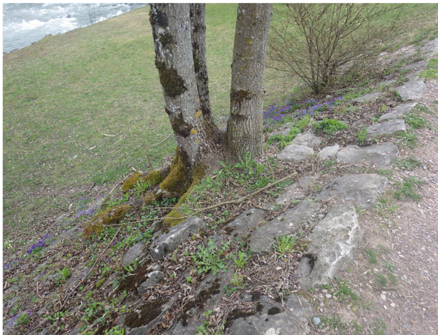
Photo n°4 – Déstructuration du perré existant
