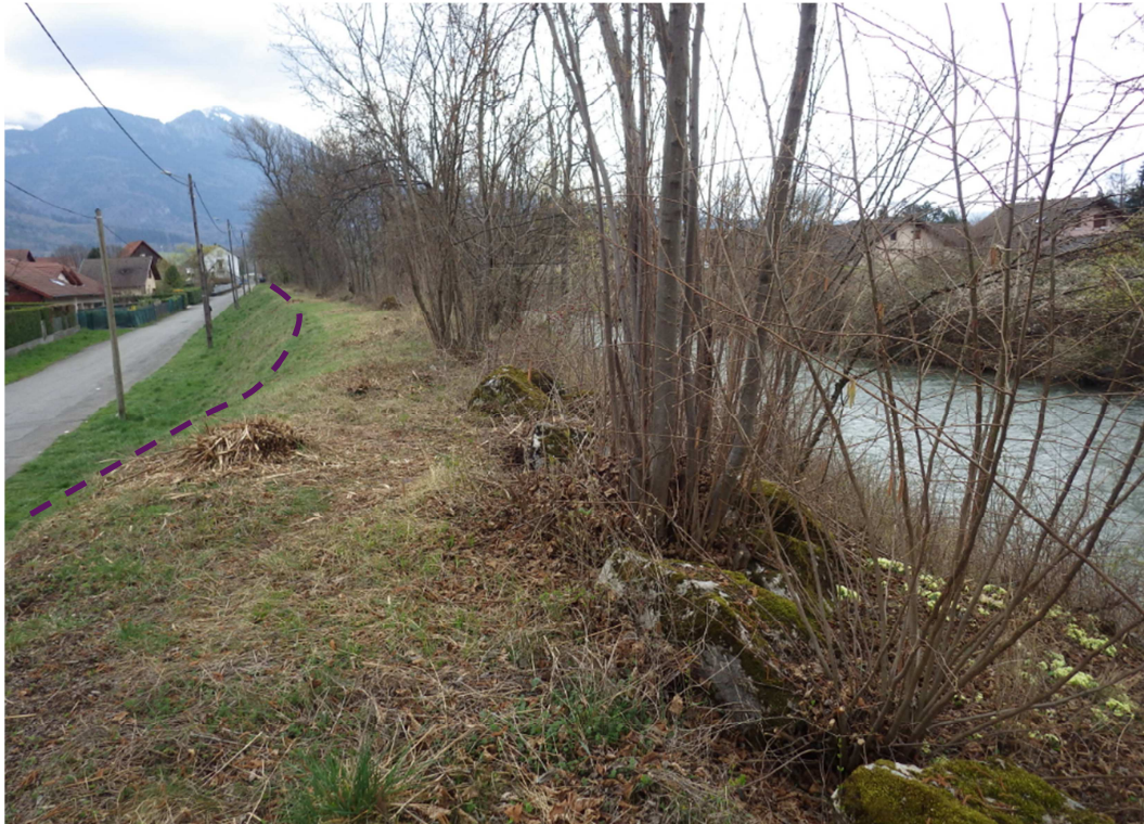
Photo n°3 : Empiètement sur la géométrie originelle de l'ouvrage – talus originel rogné
