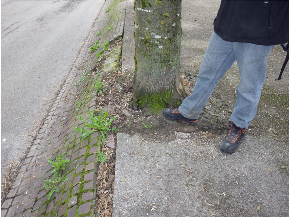
Photo n°4 – Déformation du fait du développement de la végétation arborée
