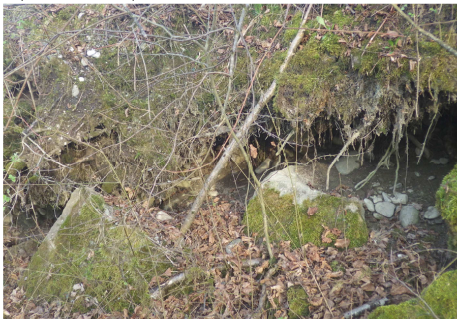
Photo n°2 : Sous cavage du pied de l'ouvrage (vue sur le tronçon VORZIERS T03)
