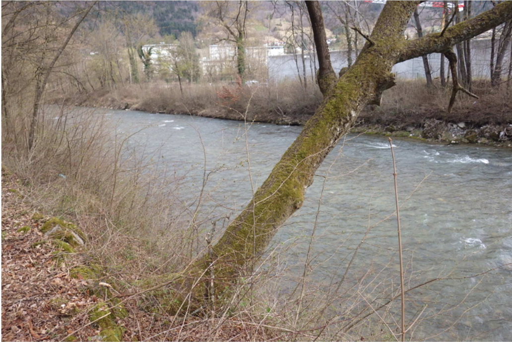
Photo n°6 - érosion le long de la prison (vue prise depuis la berge opposée)
