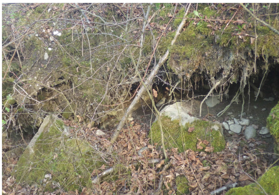
Photo n°4 – Sous cavage du pied de l'ouvrage
