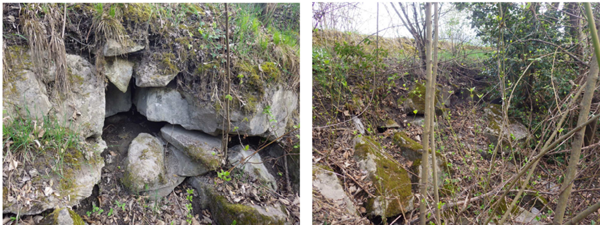
Photos n°4 et 5 : Sous-cavage et désorganisation du pied de l'ouvrage suite à affouillement/incision du lit de l'Arve
