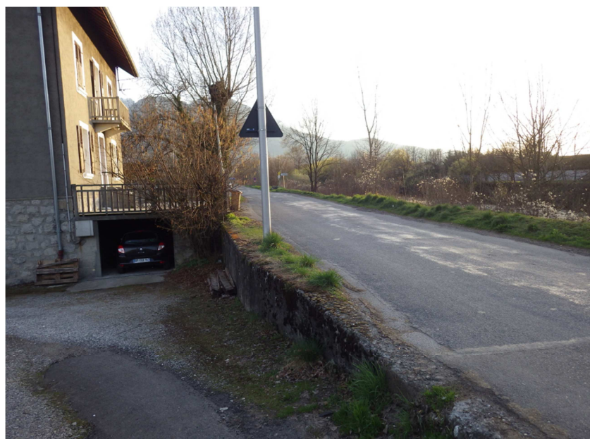
Photo n°4 : talus aval entaillé/occupée par une habitation
