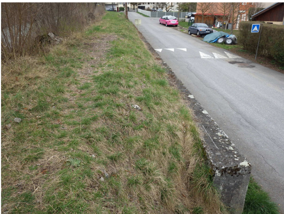
Photo n°2 : Empiètement sur la géométrie originelle de l'ouvrage – mur de soutènement
