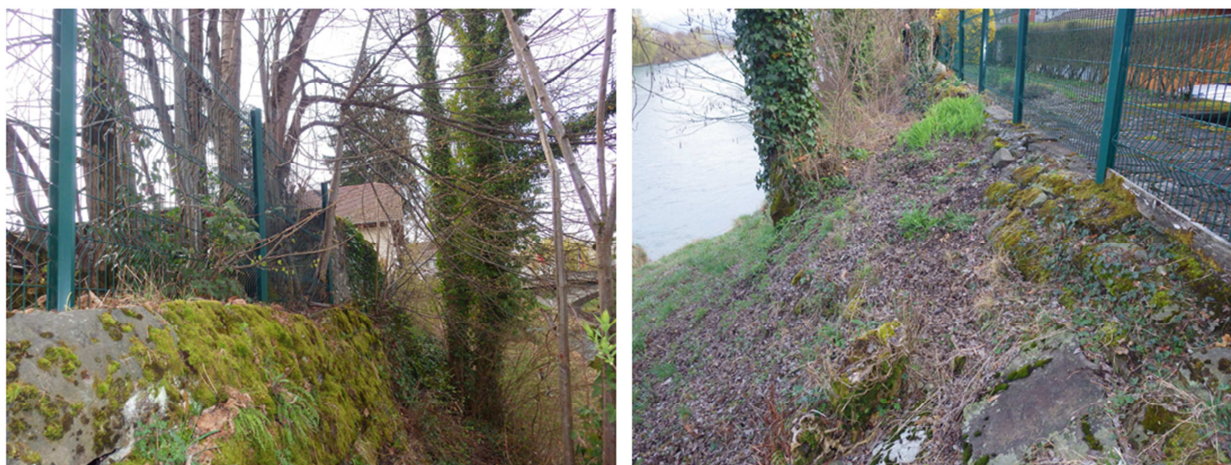
Photo n°3 et 4 – Maçonneries vétustes et végétation arborée en cours de développement
