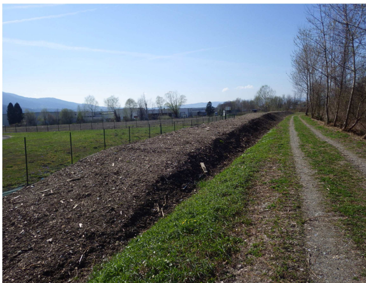
Photo n°2 : conditions de remblaiement disparates à l'arrière de l'ouvrage
