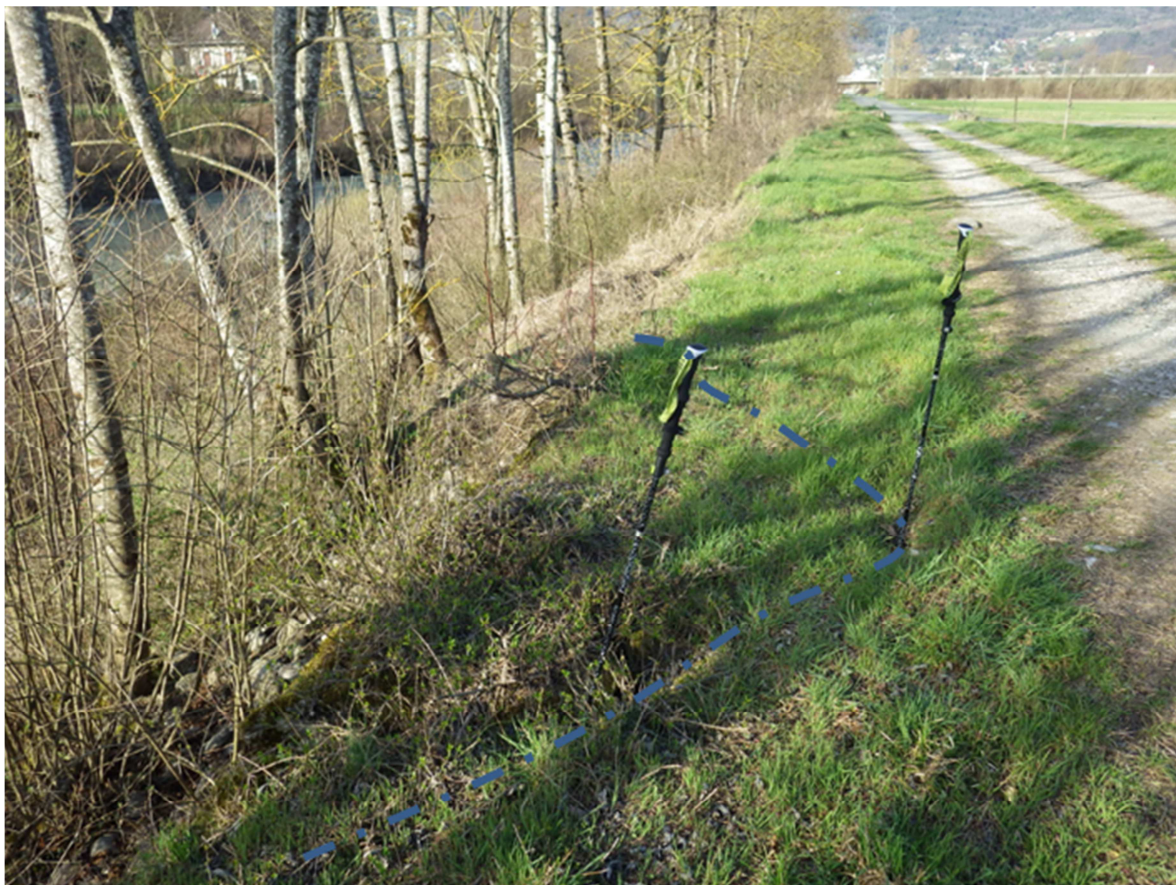
Photo n°5 – Amorce d'effondrement en crête
