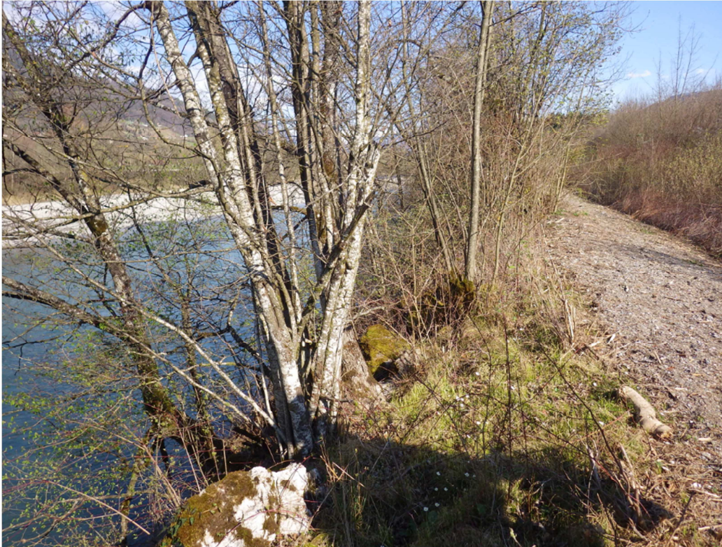
Photo n°2 – Désorganisation du talus amont
