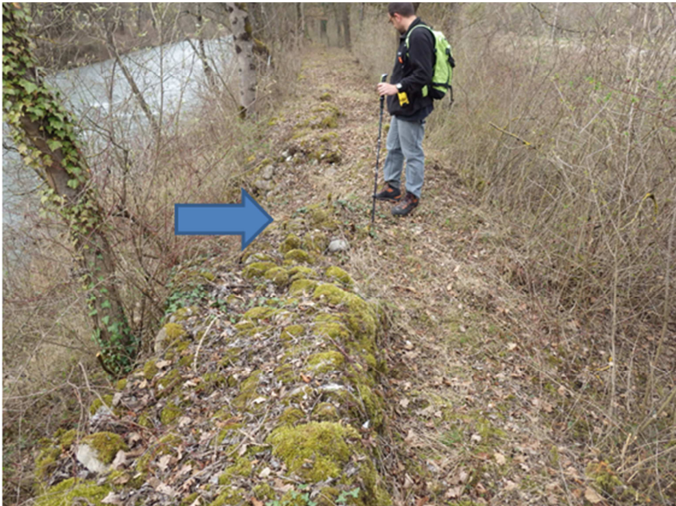
Photo n°7 – gabions éventrés et densité importante de la végétation arborée
