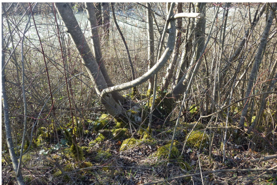
Photo n°3 - Muret disloqué du fait de la végétation
