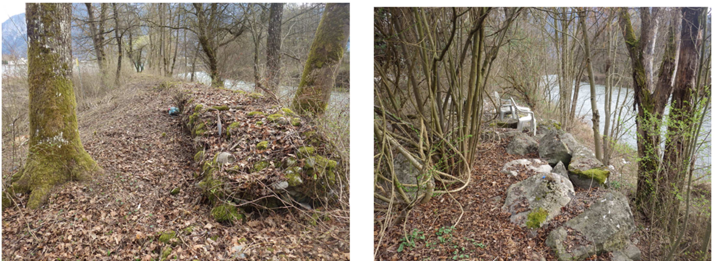
Photo n°4 et 5 - Extrémité aval de l'ouvrage : continuité discutable, points bas
