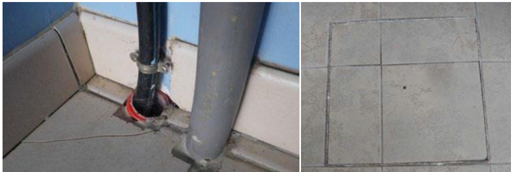
Exemples de défauts d'étanchéité
