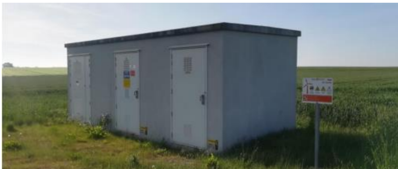
Photo 3 : exemple de poste de livraison électrique
