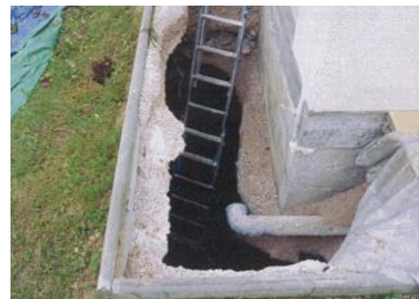
Photo 14 : Effondrement karstique de terrain à Valentigney (Source : DDRM 25, 2020)
