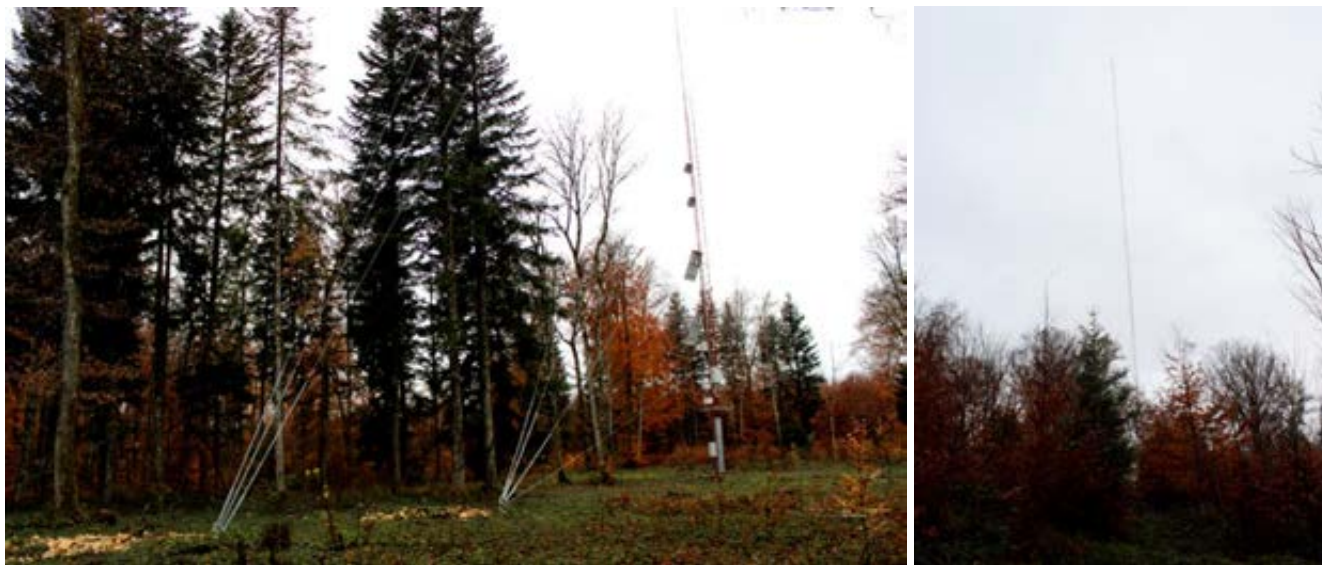
Photo 7 : Un mât de mesure a été installé sur Nancray
