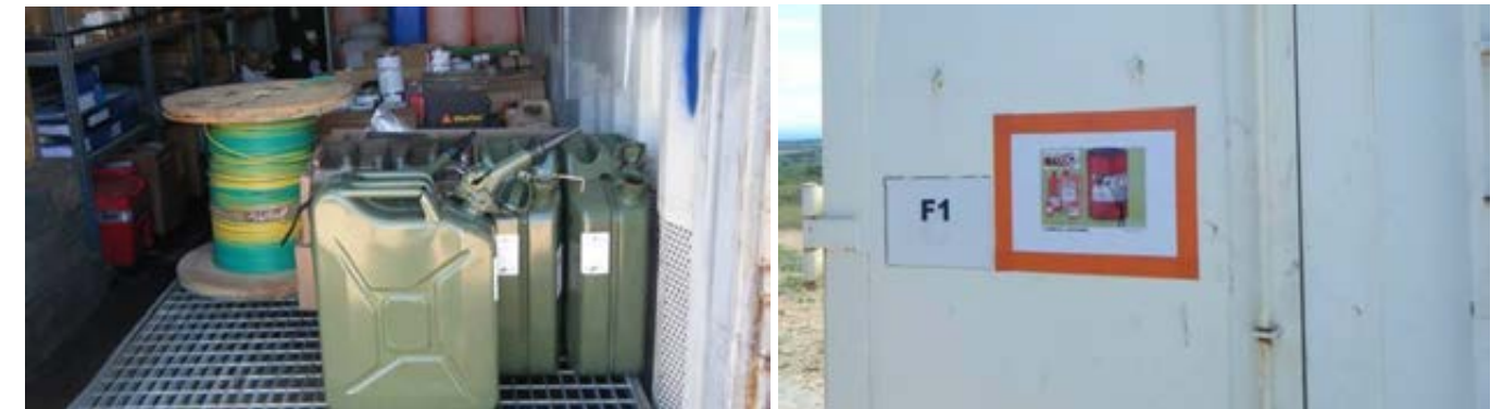
Photo 16 : Exemple de local fermé contenant des produits sur système de rétention (©Corieaulys)
