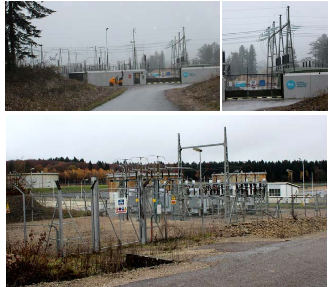
Photo 25 : Exemples de postes électriques autour de la ZIP (en haut, le poste de Saône ; en bas, le poste de Gennes)
