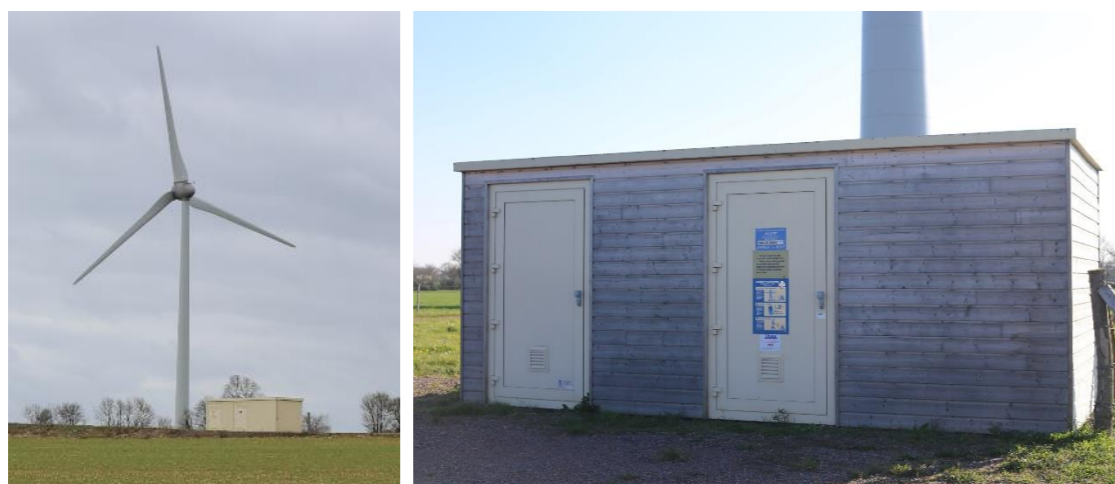
Photo 5 : exemples de poste de livraison électrique
