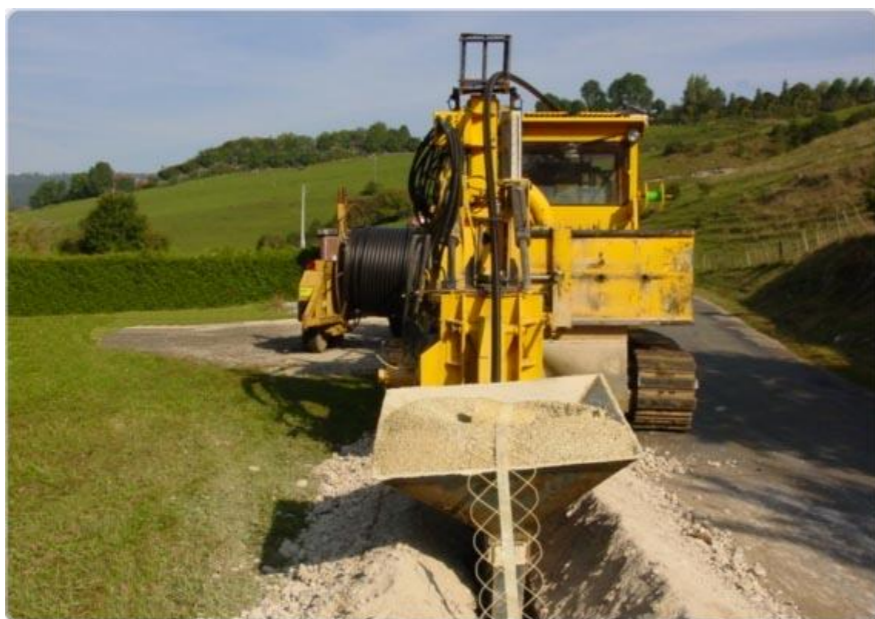
Photo 111 : la pose d'un câble souterrain depuis le poste de livraison jusqu'au réseau électrique public
