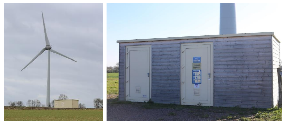
Figure 5 : exemples de poste de livraison électrique
