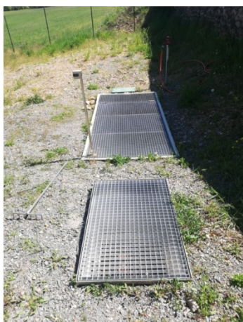
Dégrilleur au 1 er plan en très bon état. RAS. Bassin de chasse au 2 ème plan avec compteur de bâchées en très bon état également. RAS
