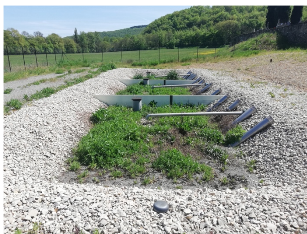
3 filtres plantés de roseaux
