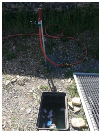
Robinet d'eau avec compteur.
