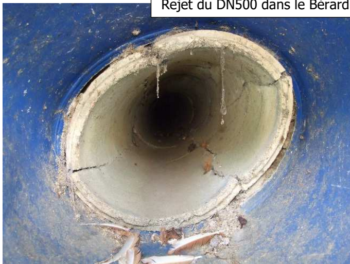
Rejet du DN500 dans le Bérardier (traversée de la RD538)
