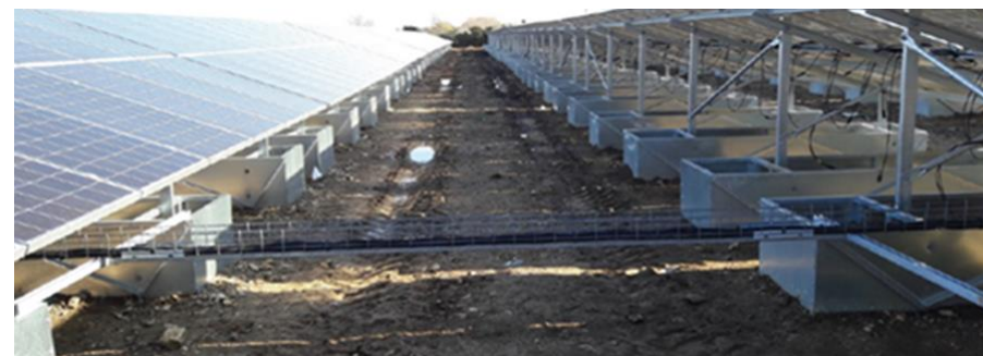
Figure 41: Exemple de câbles en fourreaux
