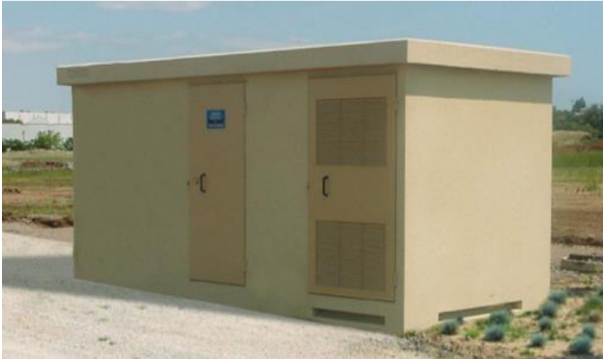
Figure 52: vue d'un poste de livraison
