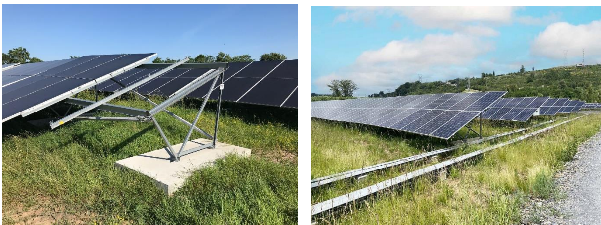
Figure 199: clichés photographiques de longrines bétons et de chemins de câbles aériens
